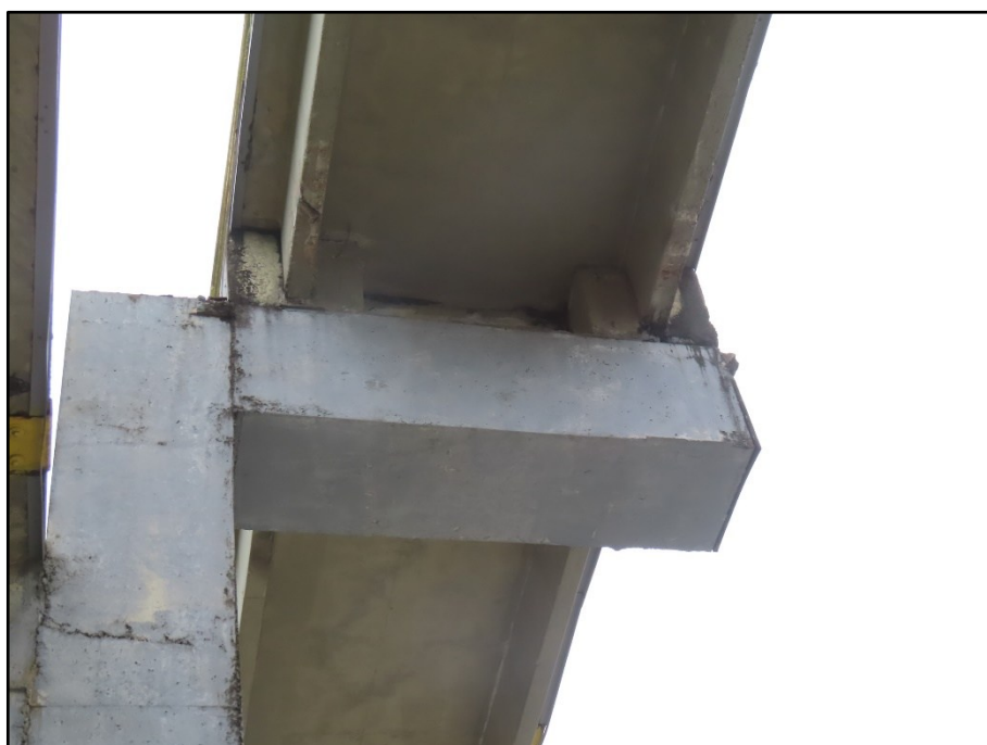
FOTO 166 Fissura horizontal na face superior da VAP4 do pilar P2, face Sul
