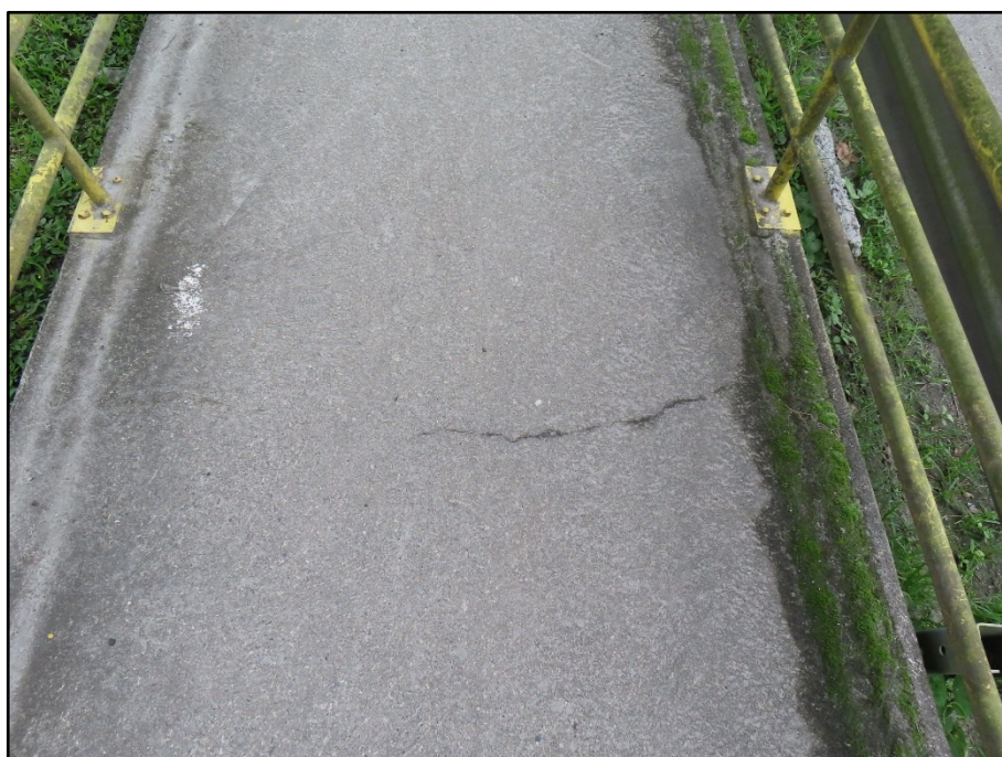
FOTO 230 Fissuras na estrutura de ENC1, face Superior
