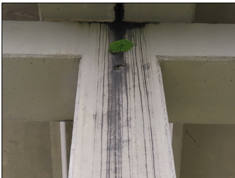
FOTO 160 Manchas de umidade no pilar P1, face Norte
