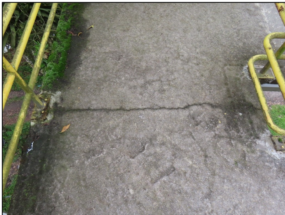
FOTO 261 Junta de dilatação JD12, face Superior
