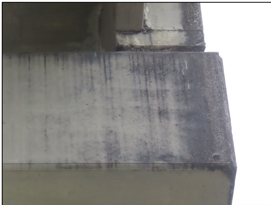
FOTO 185 Manchas de umidade na VAP1 do pilar P1, face Sul
