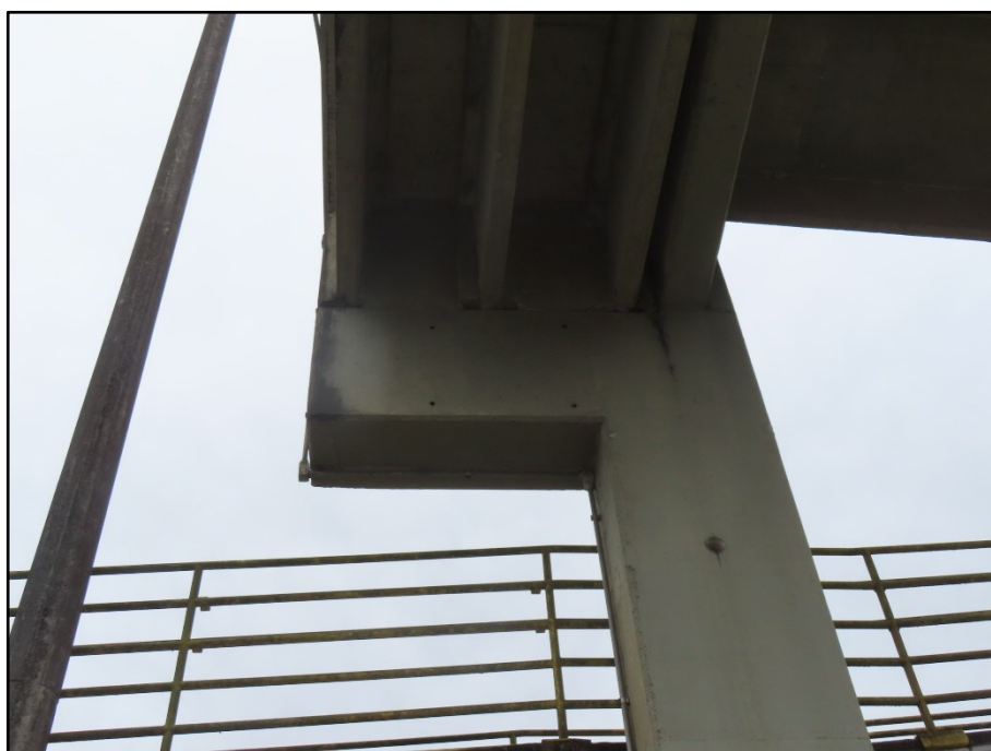
FOTO 192 Manchas de umidade na VAP8 do pilar P3, face Leste
