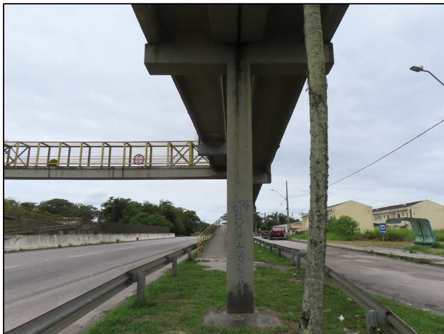
FOTO 159 Manchas de umidade no pilar P1, face Norte
