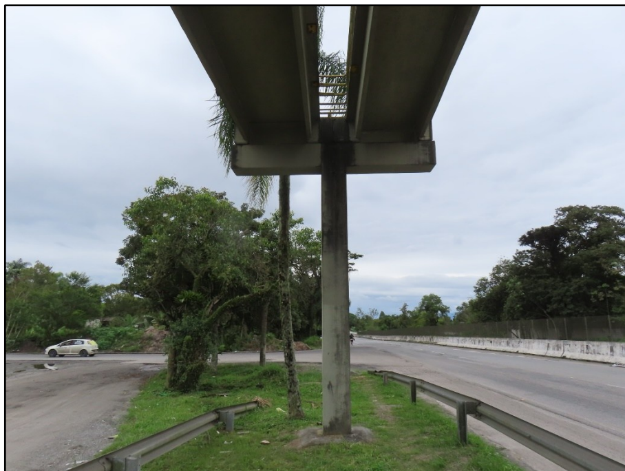
FOTO 161 Manchas de umidade no pilar P1, face Sul
