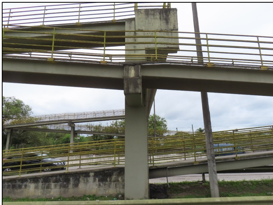
FOTO 191 Manchas de umidade na VAP6 do pilar P3, face Oeste
