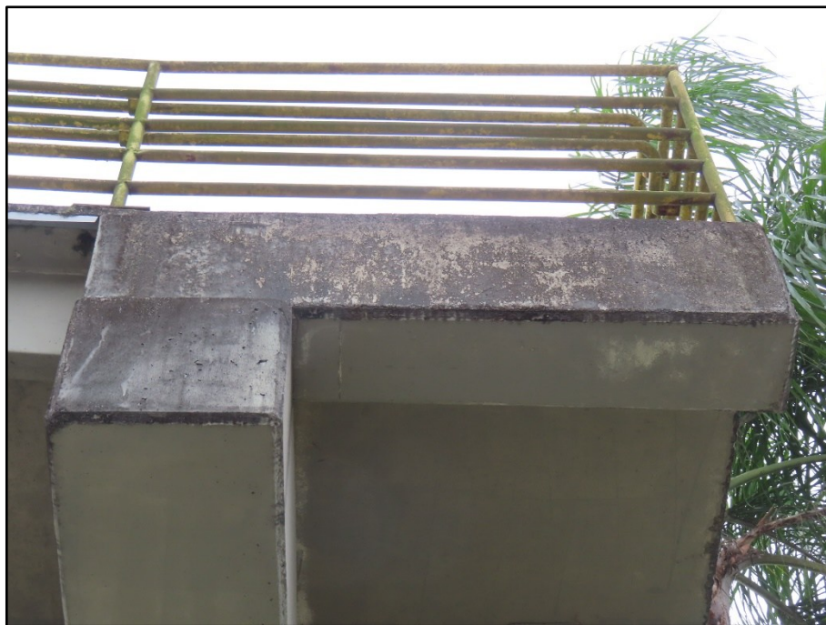
FOTO 117 Manchas de umidade na nervura 1 na BL4, face Leste
