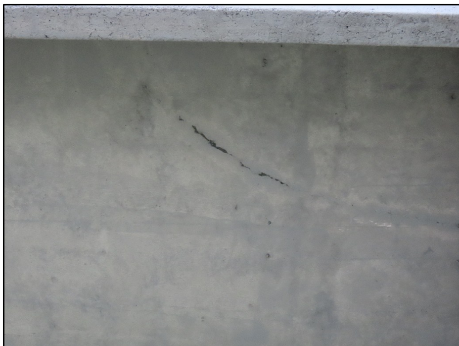
FOTO 118 Fissura diagonal na rampa 11 próximo da JD13, face Inferior
