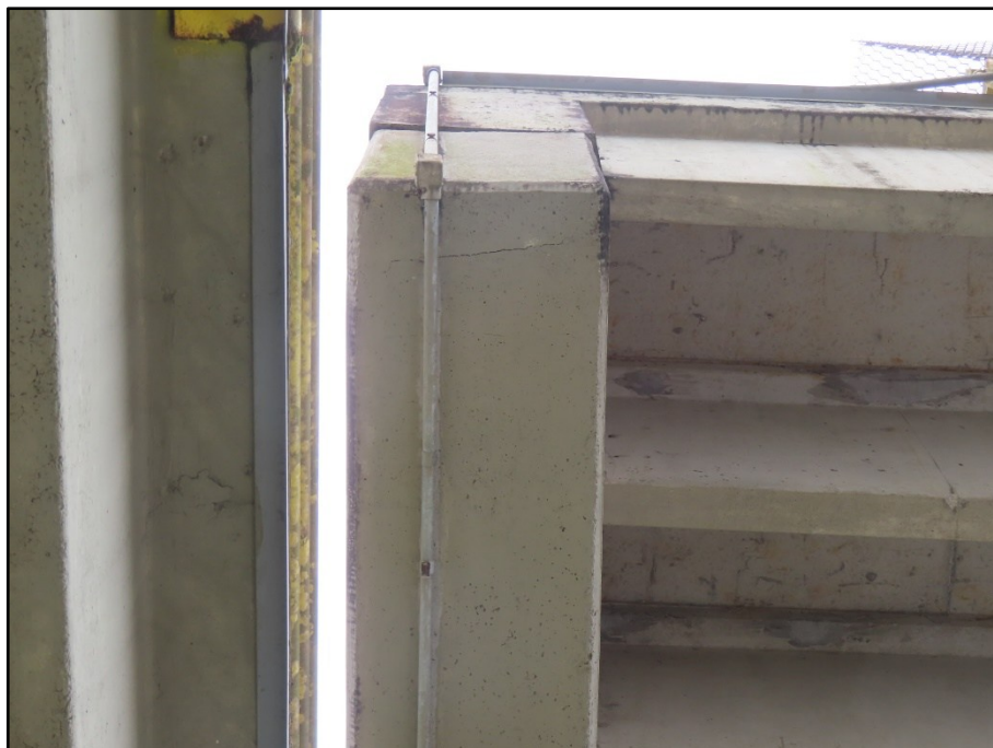
FOTO 169 Fissura transversal na VAP8 do pilar P3, face Inferior
