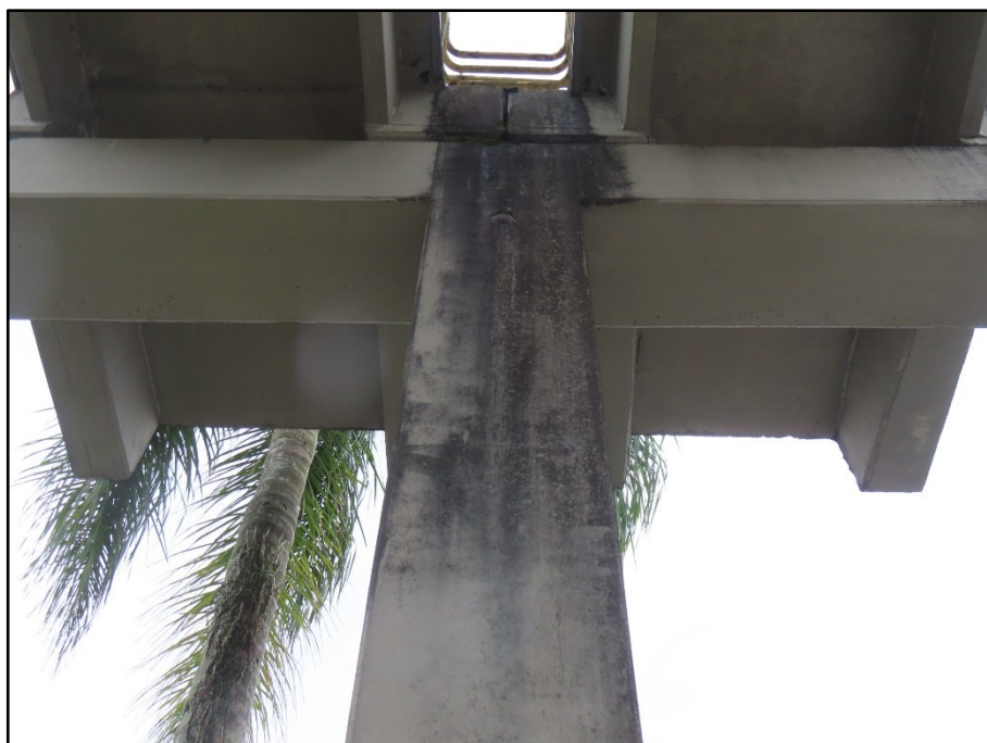
FOTO 162 Manchas de umidade no pilar P1, face Sul
