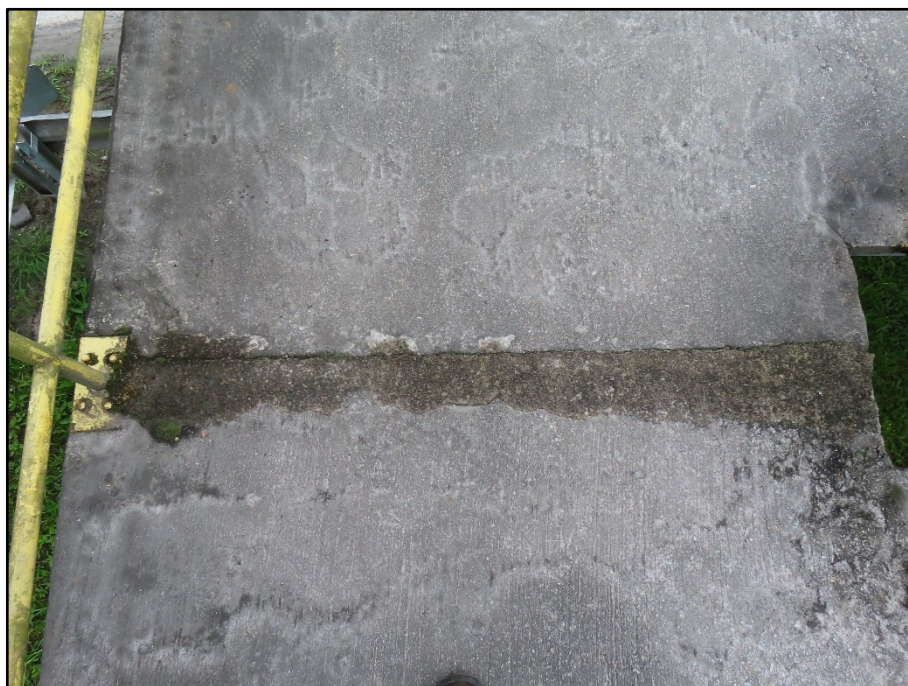
FOTO 262 Junta de dilatação JD16, face Superior
