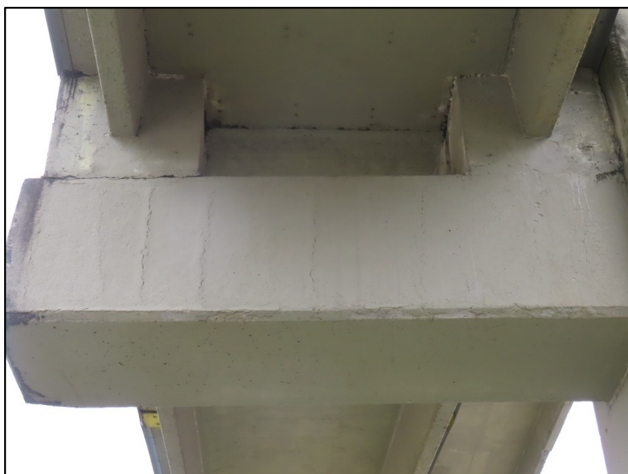
FOTO 170 Fissuras verticais na VAP6 do pilar P3, face Sul
