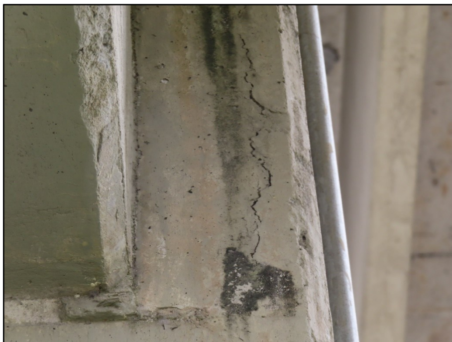
FOTO 154 Fissura vertical no canto do pilar P3, face Oeste
