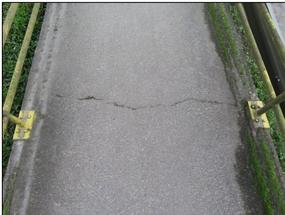
FOTO 229 Fissuras na estrutura de ENC1, face Superior
