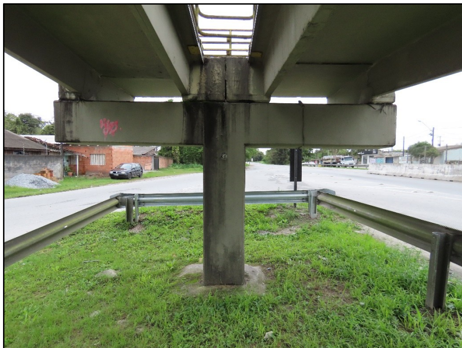
FOTO 165 Manchas de umidade pilar P10, face Norte
