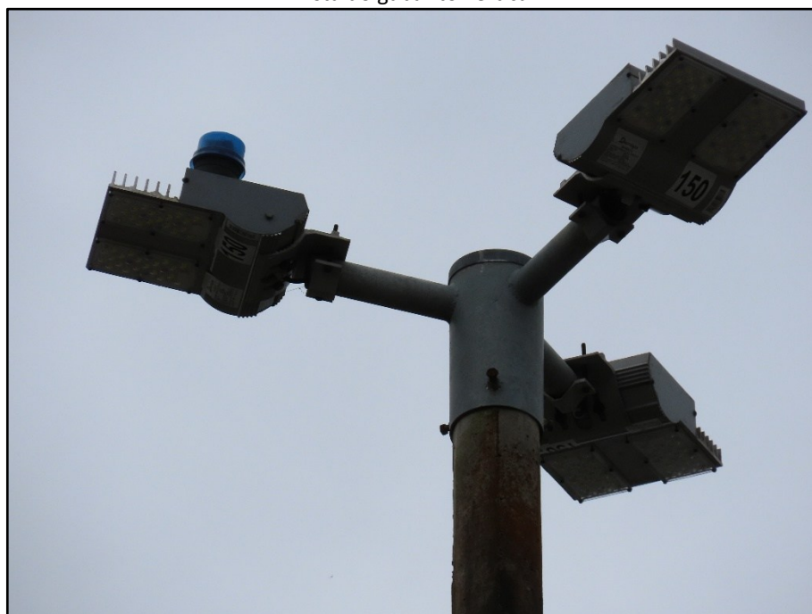
FOTO 082 Vista de elementos complementares (tubulação de utilidades iluminação etc.)
