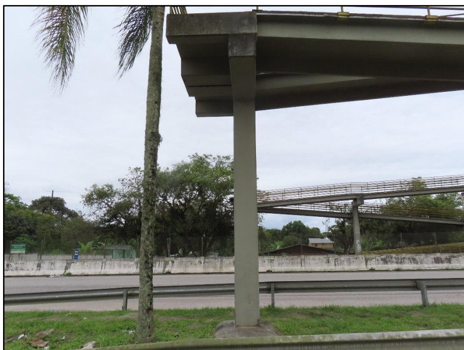
FOTO 186 Manchas de umidade na VAP2 do pilar P1, face Oeste
