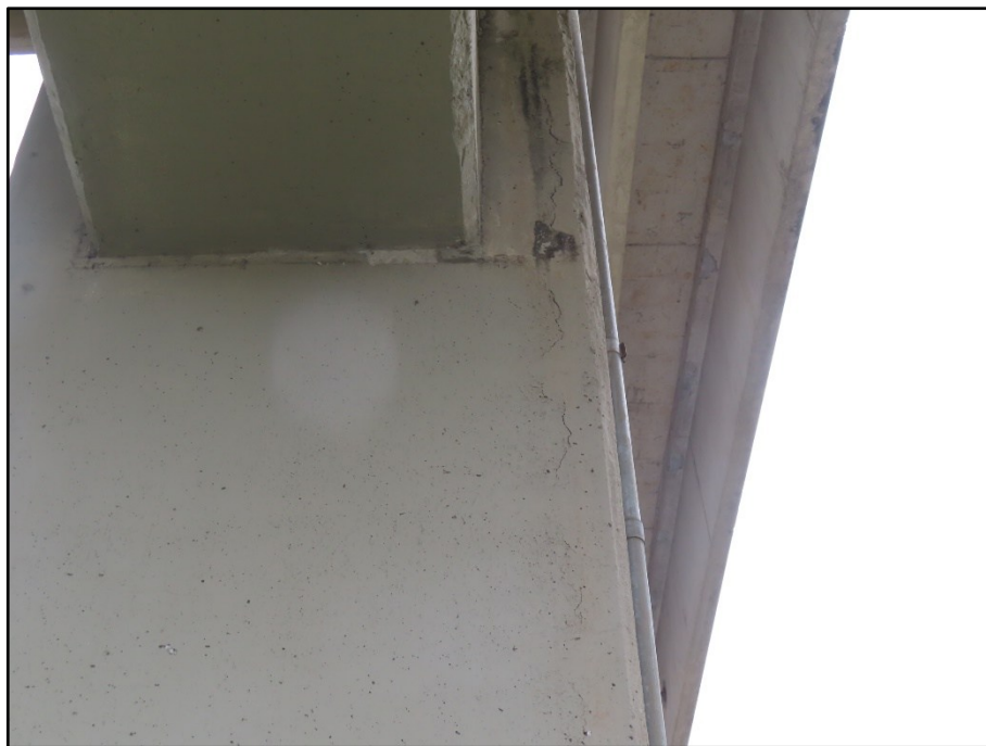
FOTO 153 Fissura vertical no canto do pilar P3, face Oeste
