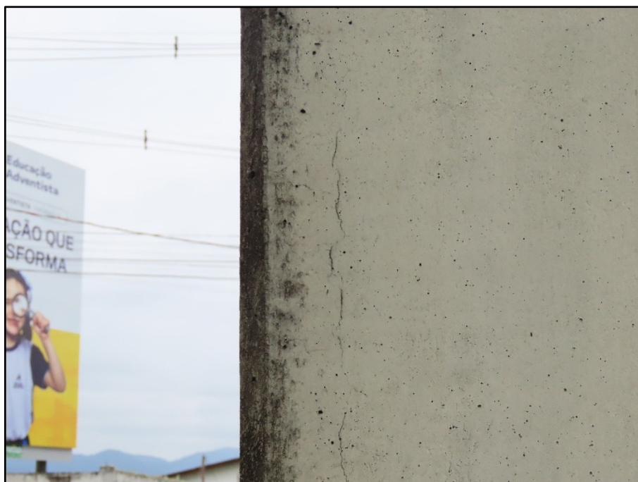
FOTO 187 Concreto disgregado no pilar P1, face Leste
