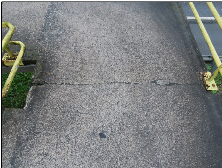
FOTO 270 Junta de dilatação JD3 com vedação deficiente, face Superior
