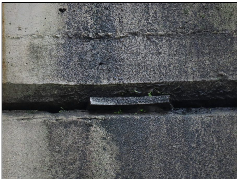
FOTO 173 AA da NV2 no pilar P6, rampa 10
