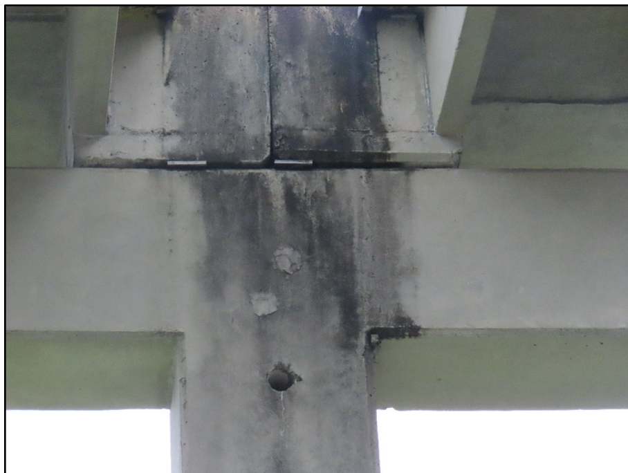
FOTO 188 Manchas de umidade no pilar P1
