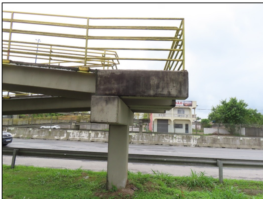
FOTO 137 Manchas de umidade na nervura 1 na BL2, face Oeste
