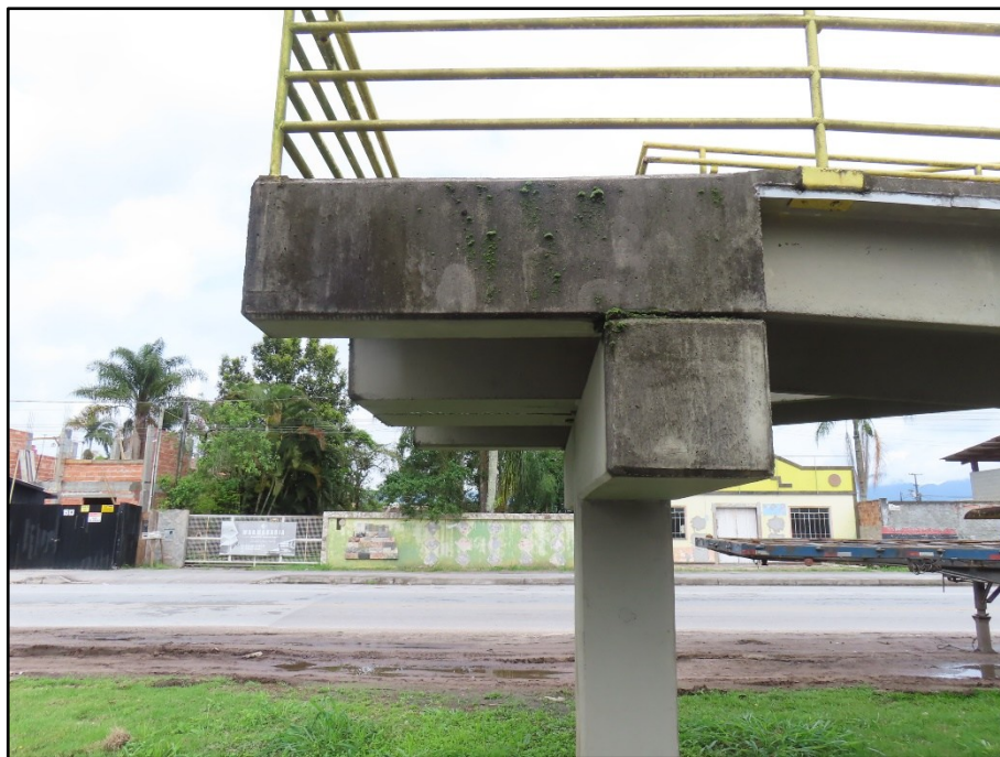
FOTO 136 Manchas de umidade na nervura 1 na BL1, face Leste
