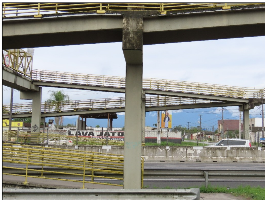
FOTO 210 Manchas de umidade na VAP15 do pilar P7, face Leste
