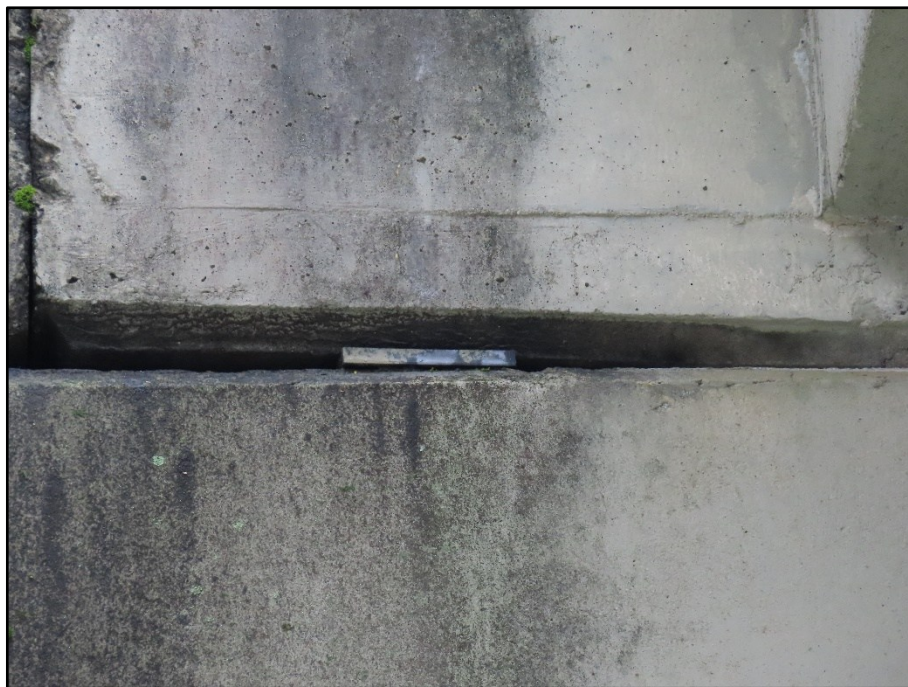
FOTO 176 AA da NV2 no pilar P6, rampa 11
