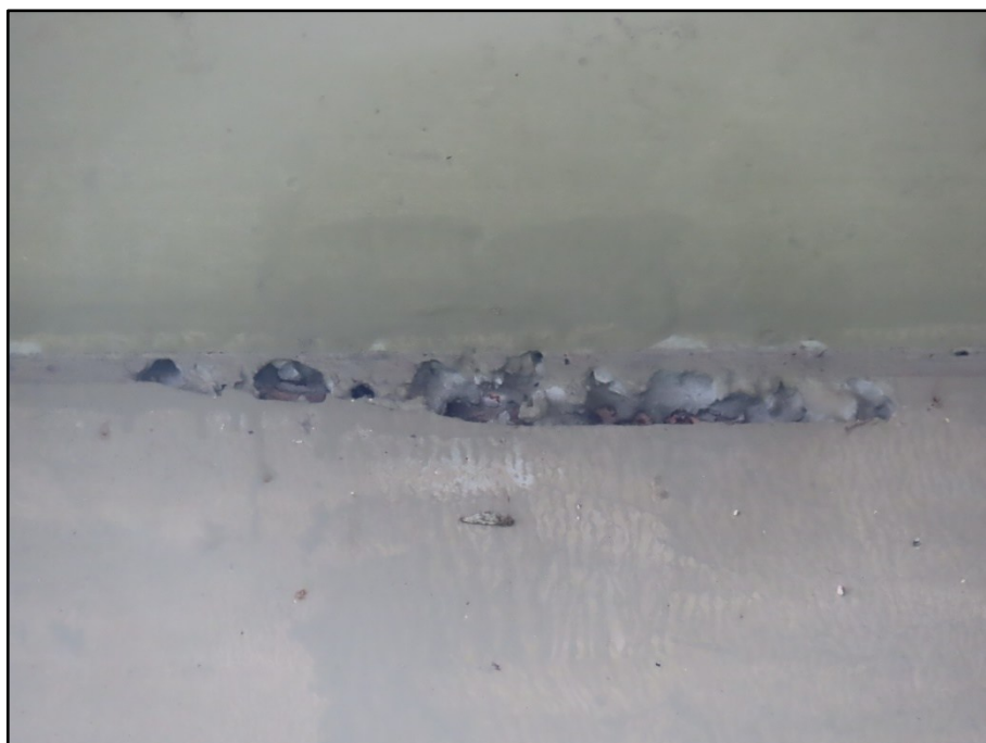
FOTO 135 Concreto segregado na nervura 1 na BL6, face Oeste
