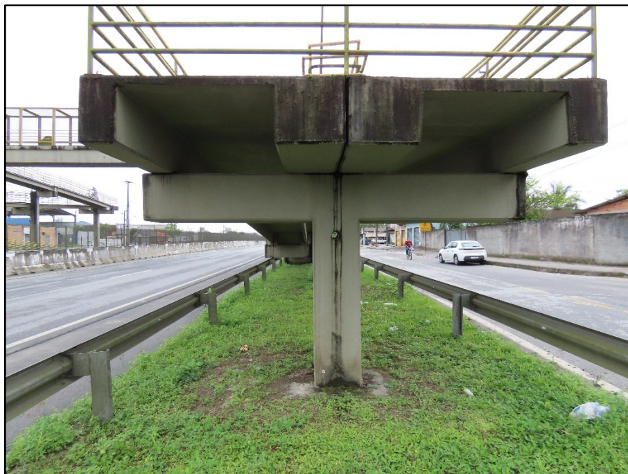
FOTO 214 Manchas de umidade nas VAP24
