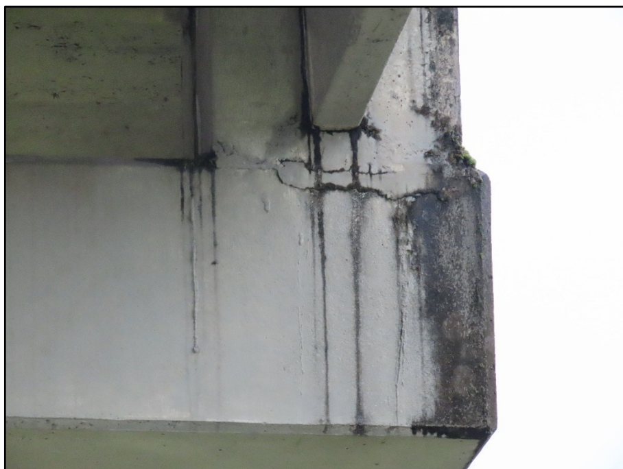
FOTO 197 Manchas de umidade na VAP3 do pilar P2, face Norte
