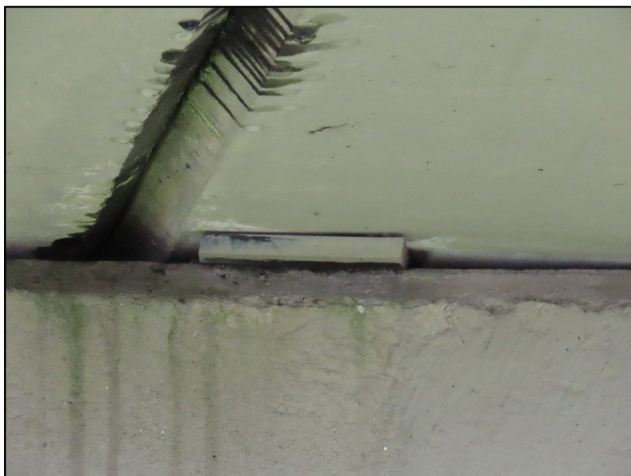
FOTO 167 AA da NV2 no pilar P5, rampa 2
