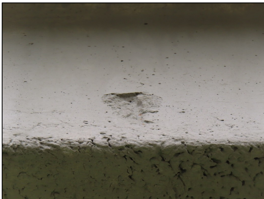
FOTO 101 Concreto disgregado na nervura 2 da rampa 4, face Leste
