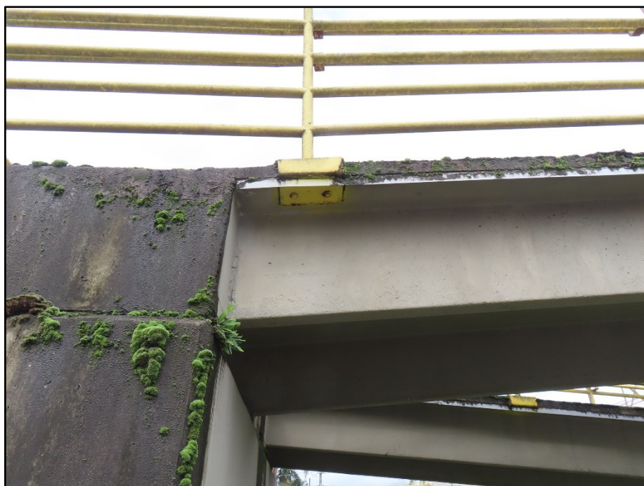
FOTO 127 Fissuras na nervura 1 da rampa 14, face Leste, próximo do pilar P10
