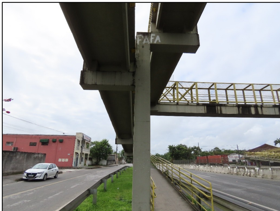
FOTO 206 Manchas de umidade na VAP15 do pilar P7, face Norte
