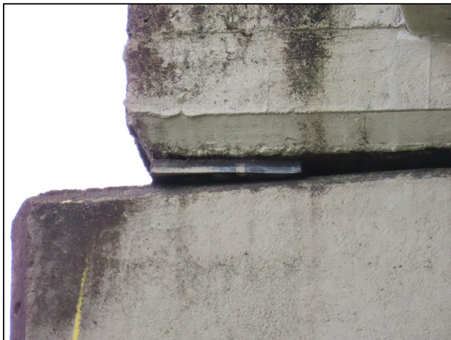
FOTO 172 AA da NV1 no pilar P6, rampa 10
