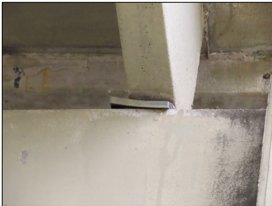
FOTO 182 AA da NV2 no pilar P3, rampa 8
