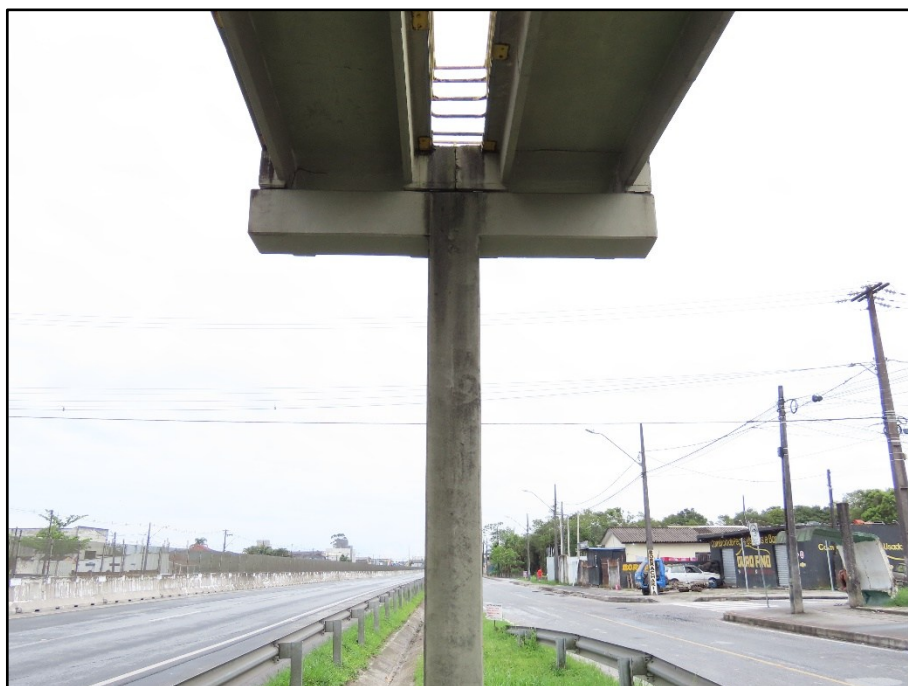
FOTO 191 Manchas de umidade no pilar P6
