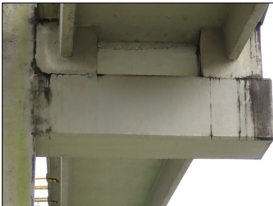
FOTO 209 Manchas de umidade na VAP15 do pilar P7, face Sul
