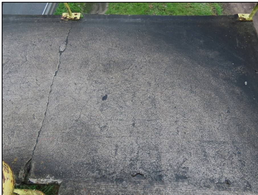
FOTO 236 Fissuras mapeadas na rampa 3, na região da BL2, face Superior
