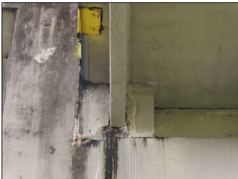
FOTO 215 Fissura na transição entre o bloco de apoio x laje, com eflorescências, bloco de apoio da nervura 2 na VAP3 do pilar P2, face Norte
