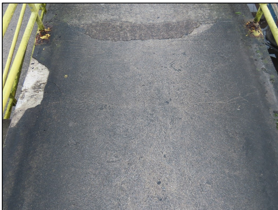
FOTO 237 Fissura transversal e concreto disgregado (desplacamento do piso) na rampa 4, na região próxima à junta de concretagem J4, face Superior
