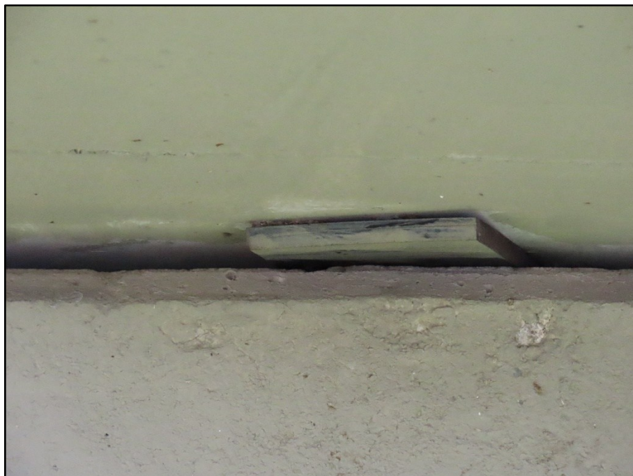
FOTO 170 AA da NV2 no pilar P5, rampa 3
