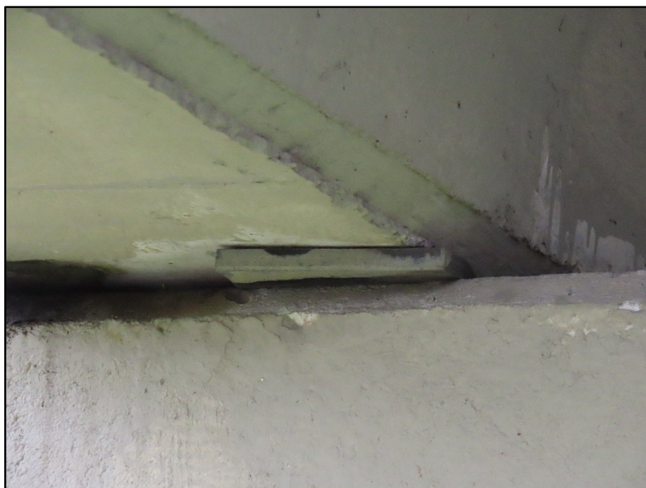
FOTO 169 AA da NV1 no pilar P5, rampa 3
