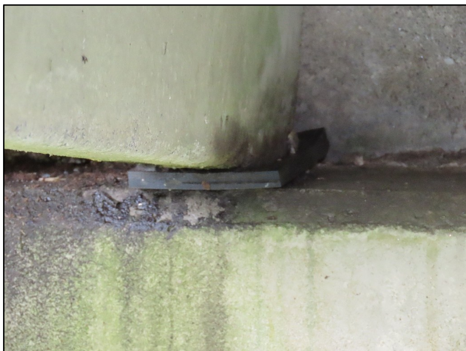
FOTO 179 AA da NV2 no pilar P3, rampa 1
