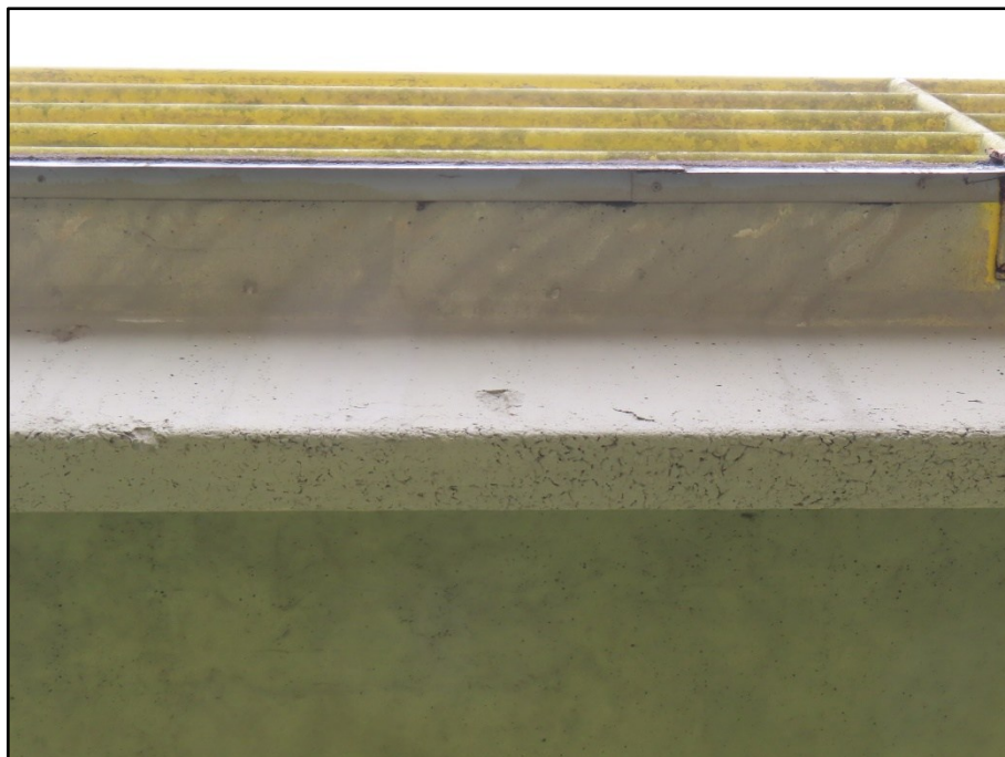
FOTO 100 Concreto disgregado na nervura 2 da rampa 4, face Leste
