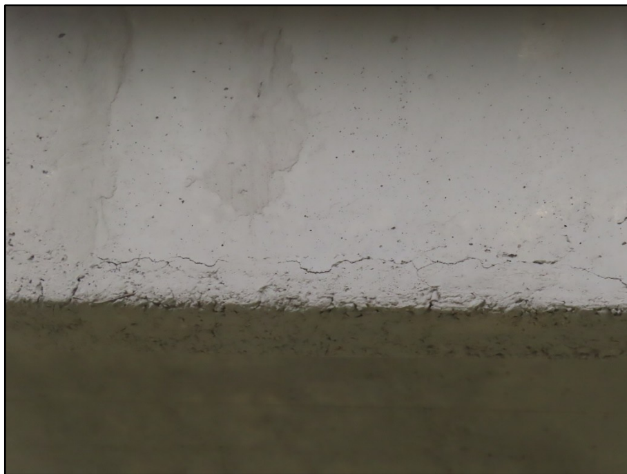
FOTO 126 Fissuras na nervura 2 da rampa 12, face Oeste
