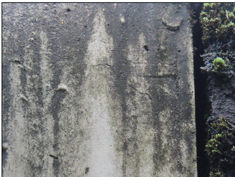
FOTO 149 Fissuras na VT próxima da JD16, face Norte da BL7
