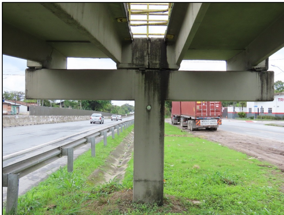
FOTO 190 Manchas de umidade no pilar P5
