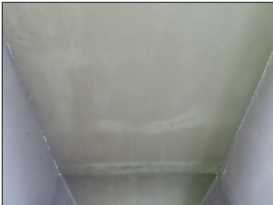
FOTO 242 Fissuras na rampa 14, próximo do pilar P10, face Inferior
