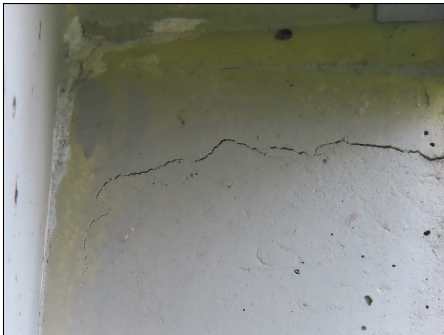
FOTO 148 Fissuras na VT próxima da JD16, face Norte da BL7
