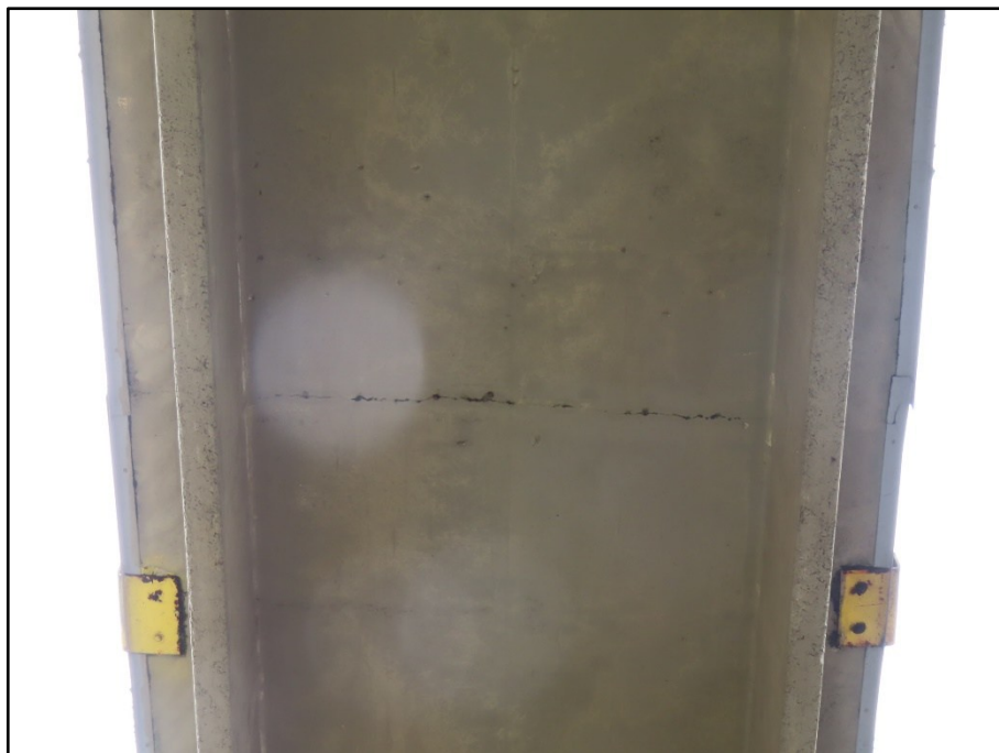
FOTO 102 Fissura transversal na rampa 10, face Inferior
