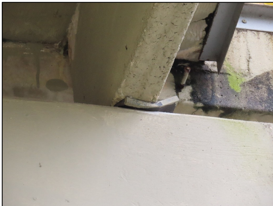
FOTO 184 AA da NV1 no pilar P8, rampa 9
