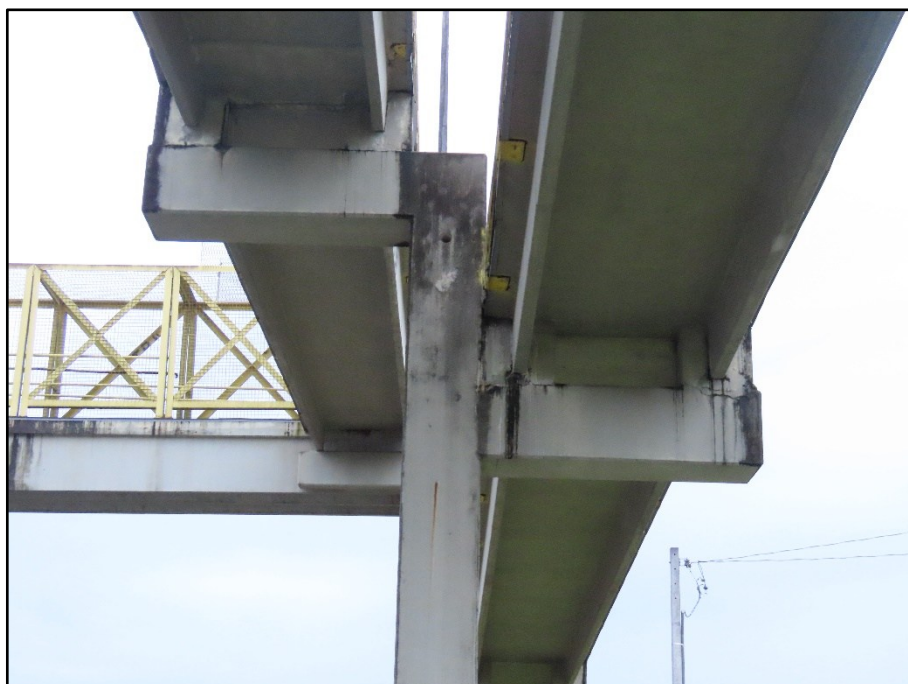
FOTO 189 Manchas de umidade no pilar P2
