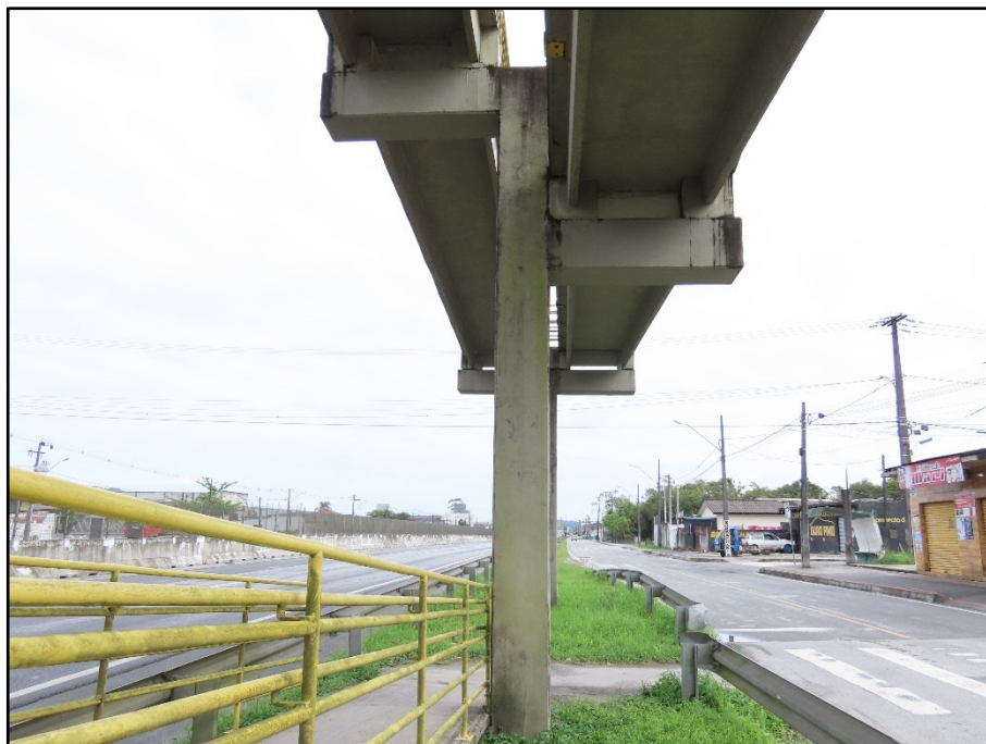
FOTO 208 Manchas de umidade na VAP15 do pilar P7, face Sul
