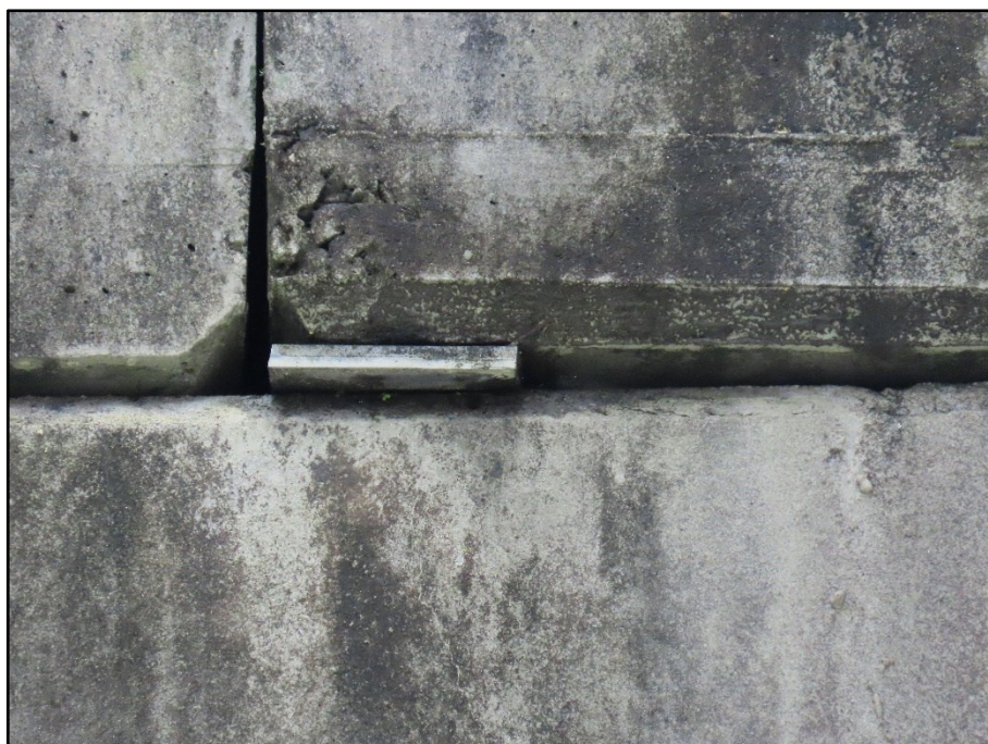
FOTO 163 AA da NV2 no pilar P1, rampa 7
