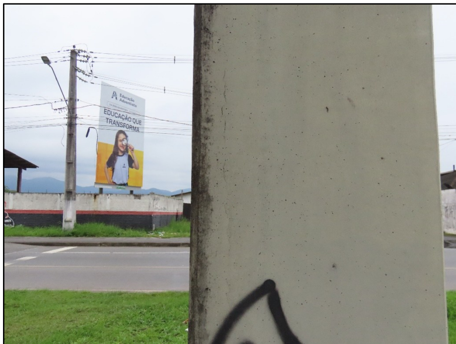
FOTO 186 Concreto disgregado no pilar P1, face Leste
