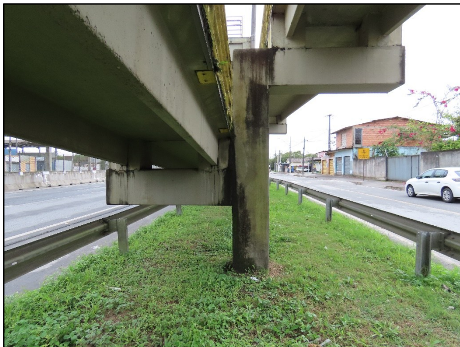
FOTO 192 Manchas de umidade no pilar P9
