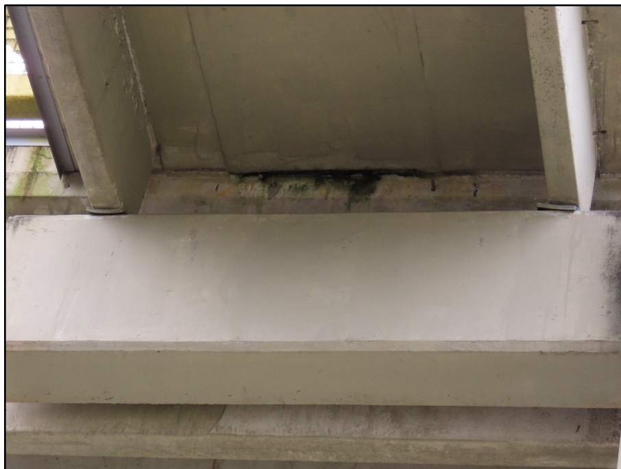
FOTO 180 AA's da NV1 e NV2, no pilar P3, rampa 8
