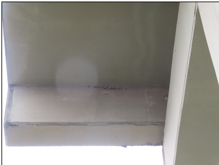
FOTO 134 Concreto segregado na nervura 1 na BL6, face Oeste
