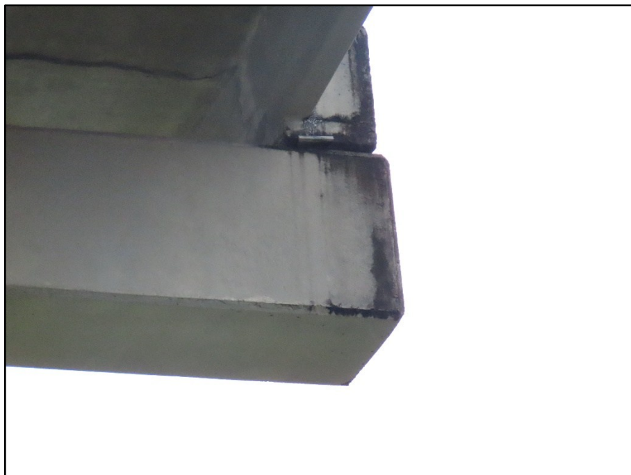
FOTO 196 Manchas de umidade na VAP1 do pilar P1, face Sul
