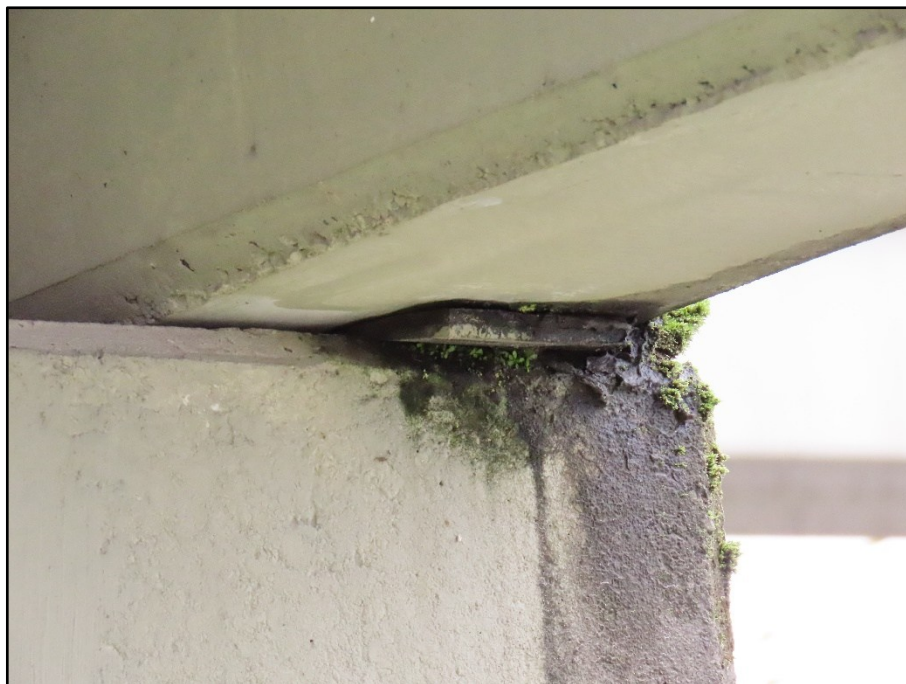
FOTO 166 AA da NV1 no pilar P5, rampa 2
