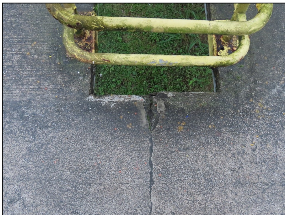
FOTO 277 Concreto disgregado e armadura exposta na JD3, face Superior
