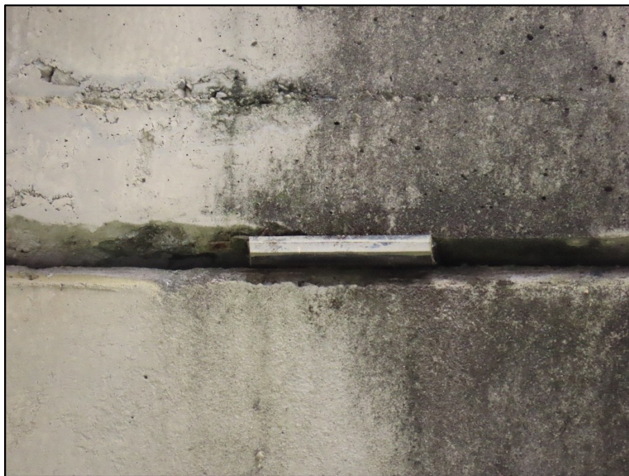
FOTO 160 AA da NV2 no pilar P1, rampa 6
