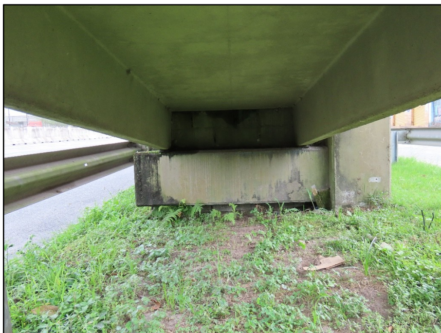
FOTO 211 Manchas de umidade na VAP17 do pilar P8, face Sul
