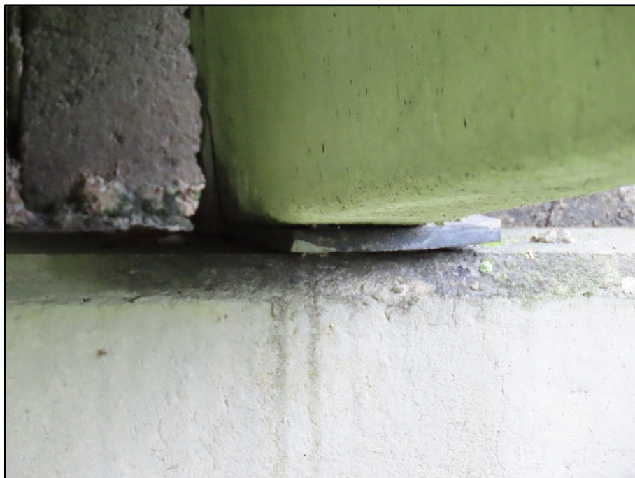
FOTO 178 AA da NV1 no pilar P3, rampa 1
