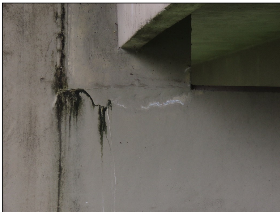
FOTO 193 Fissuras com eflorescências na VAP21 do pilar P9, face Norte
