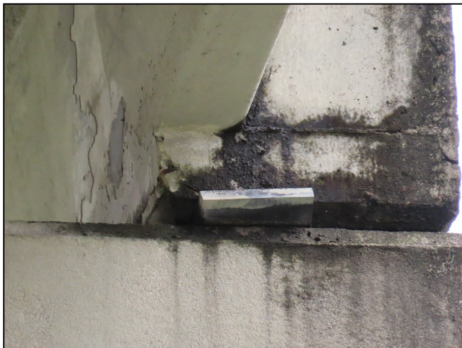
FOTO 162 AA da NV1 no pilar P1, rampa 7
