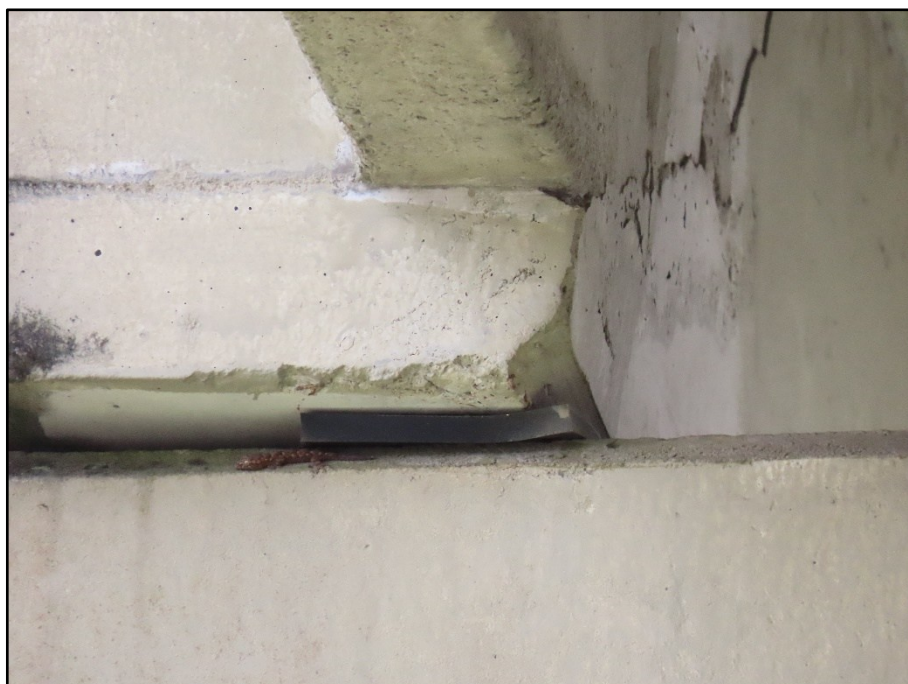
FOTO 159 AA da NV1 no pilar P1, rampa 6
