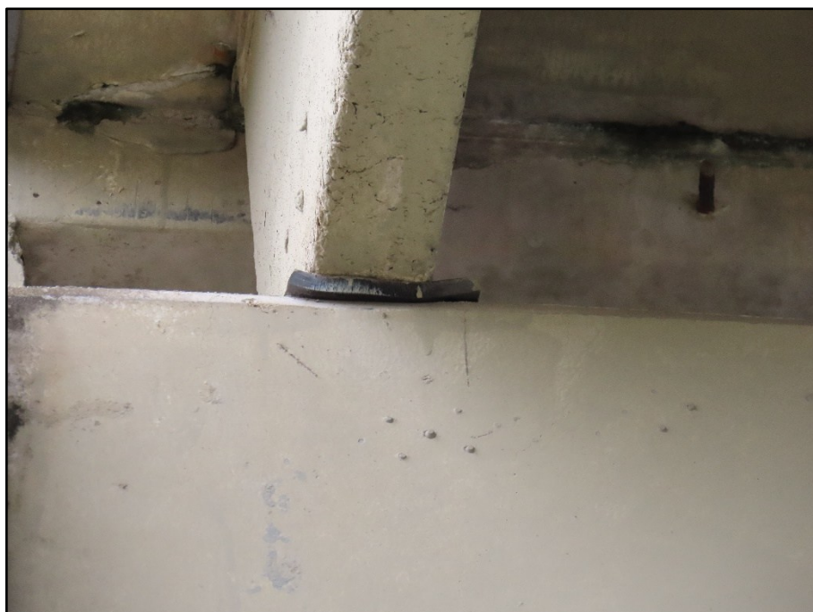
FOTO 185 AA da NV2 no pilar P8, rampa 9
