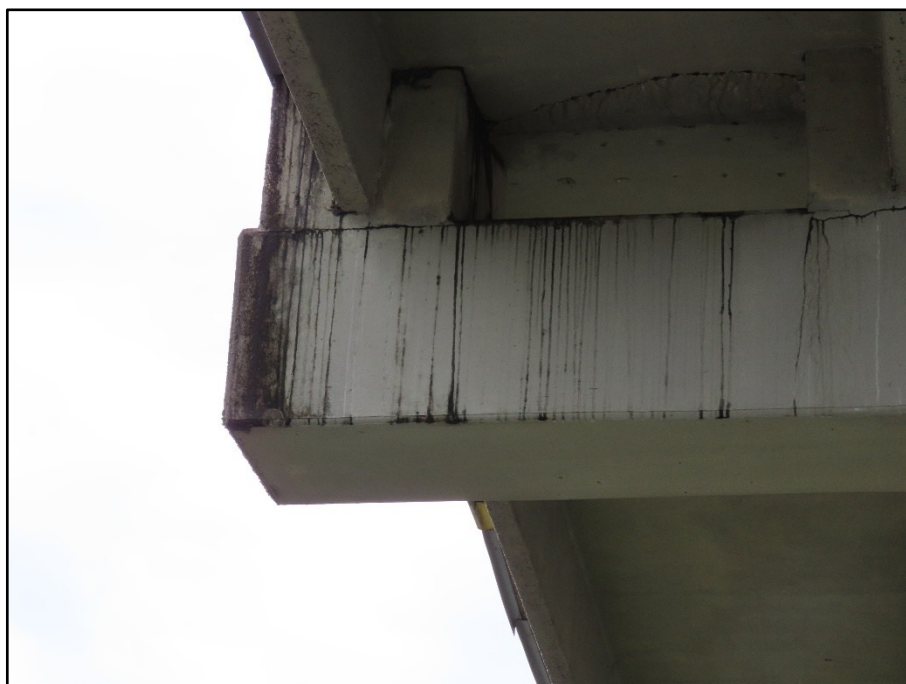
FOTO 207 Manchas de umidade na VAP15 do pilar P7, face Norte
