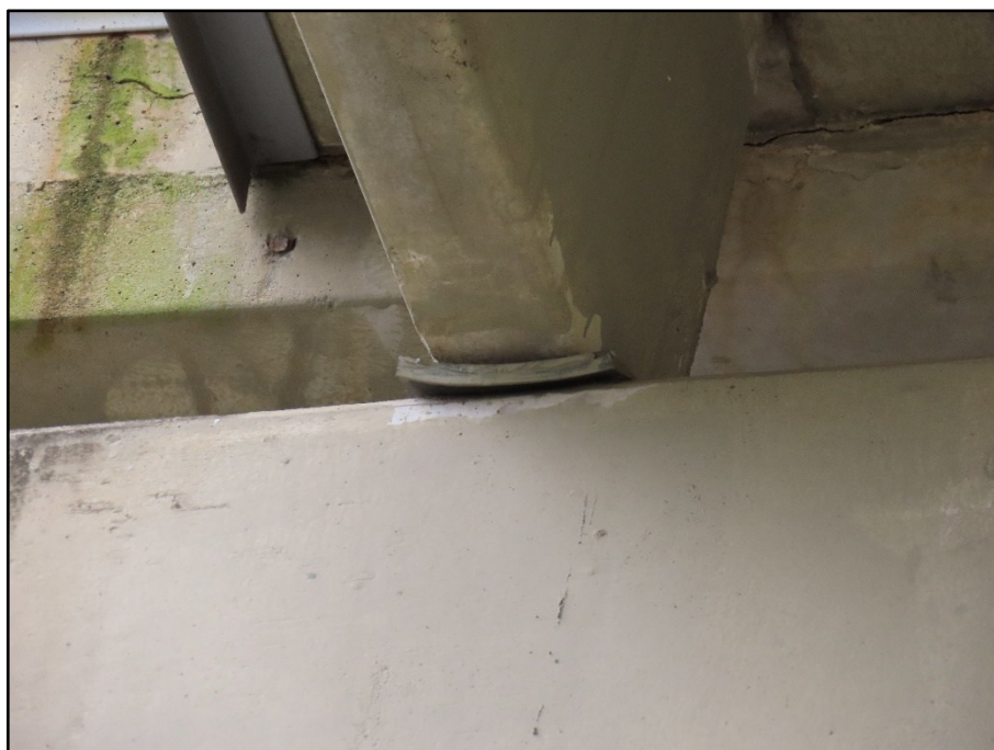
FOTO 181 AA da NV1 no pilar P3, rampa 8
