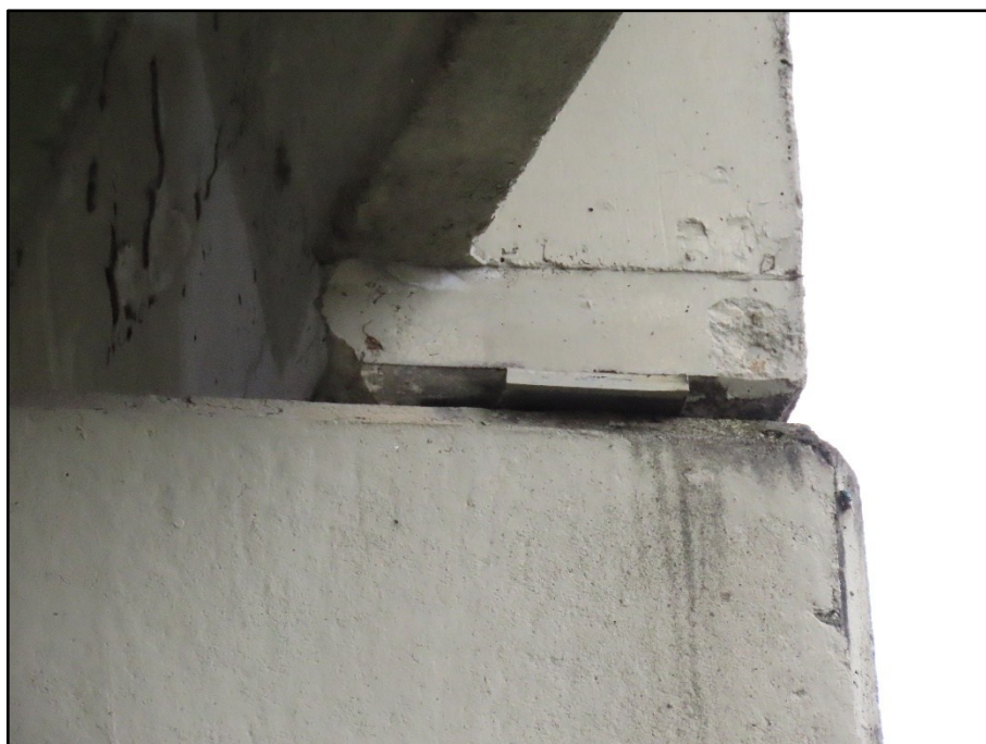
FOTO 175 AA da NV1 no pilar P6, rampa 11
