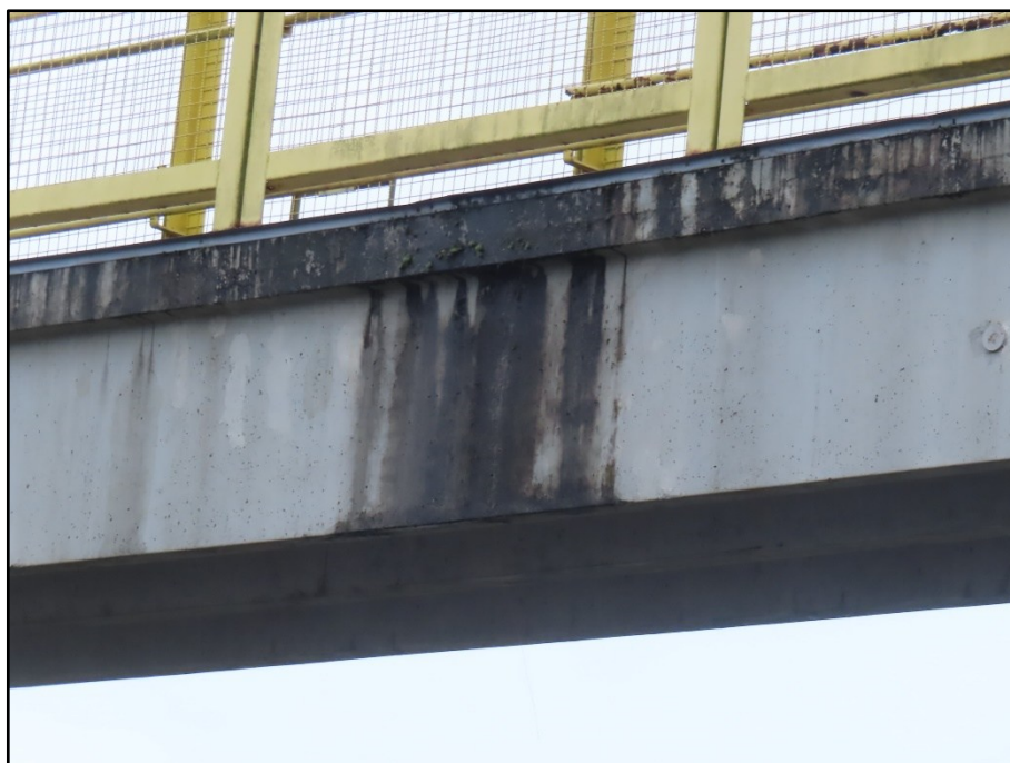
Foto 141 Idem foto anterior. Viga longarina VL1, face Norte.
