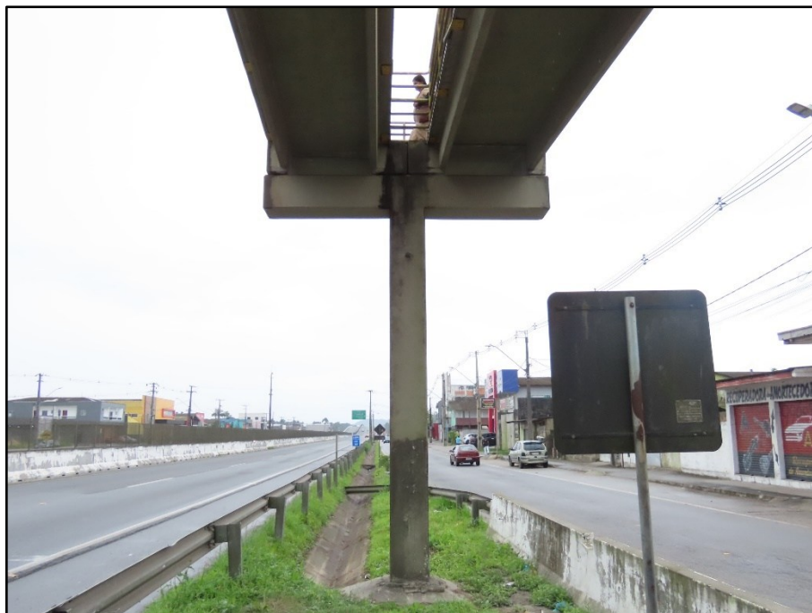
Foto 191 Manchas de umidade no pilar P6, face Sul.
