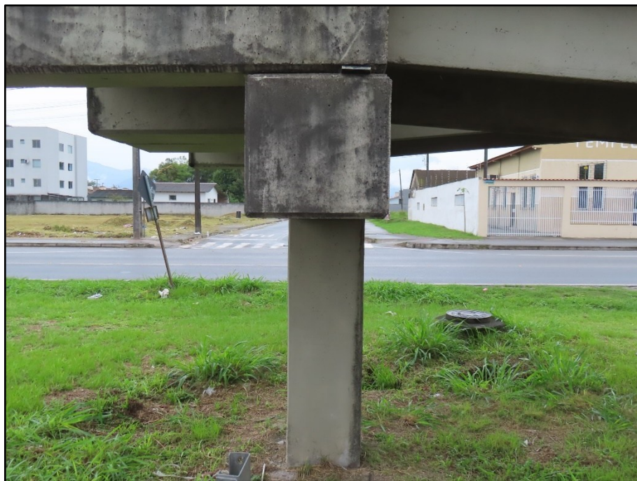
Foto 237 Manchas de umidade na VAP11 do pilar 5, face Leste.
