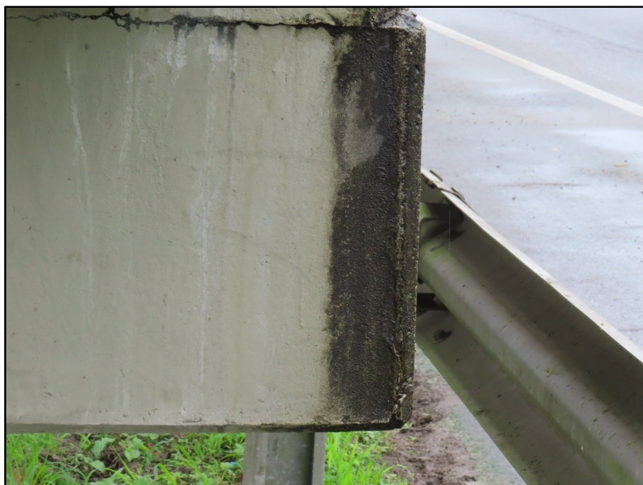
Foto 232 Vista aproximada da foto anterior. Manchas de umidade na VAP9 do pilar P4, face Sul.
