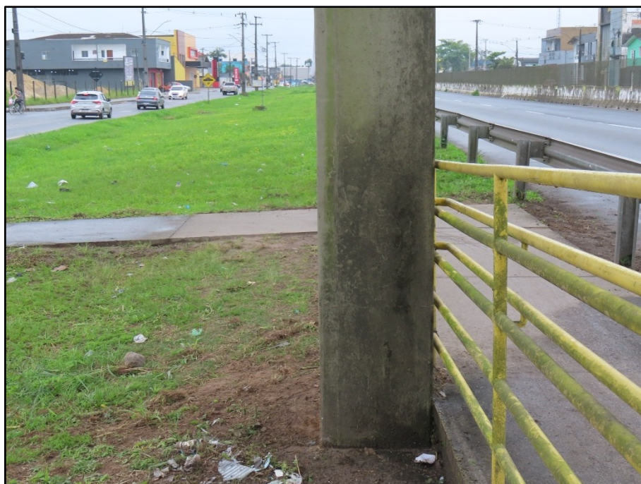
Foto 182 Idem foto anterior. Manchas de umidade no pilar P2, face Sul.
