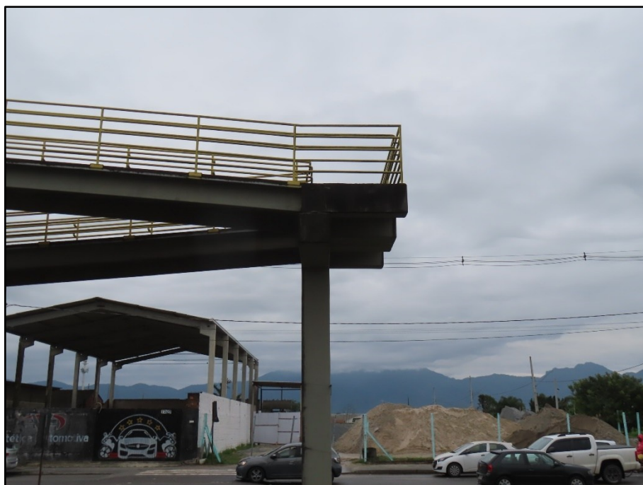
Foto 114 Manchas de umidade na nervura 1 na BL4, face Leste
