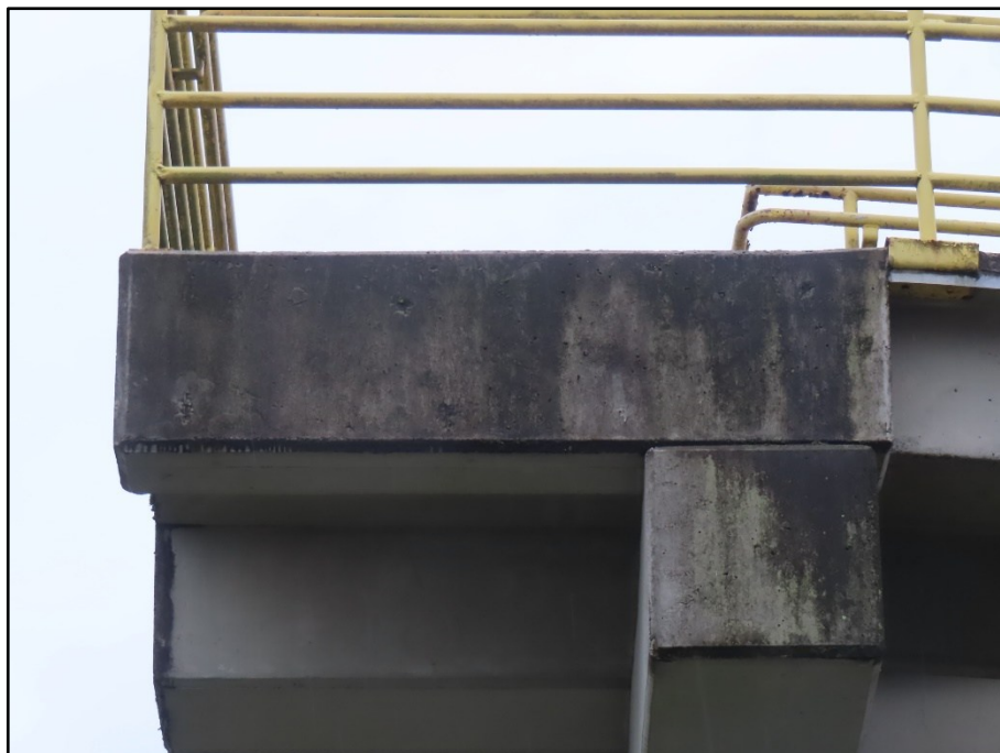
Foto 113 Manchas de umidade na nervura 1 na BL3, face Oeste
