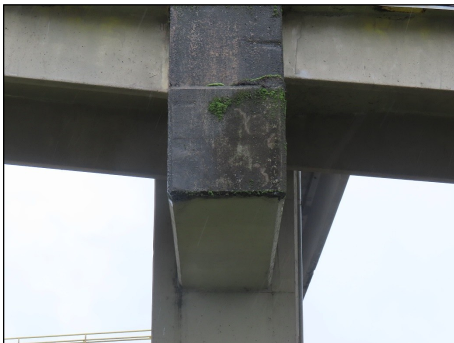
Foto 228 Vista aproximada da foto anterior. Manchas de umidade na VAP 6 do pilar P3, face Oeste.
