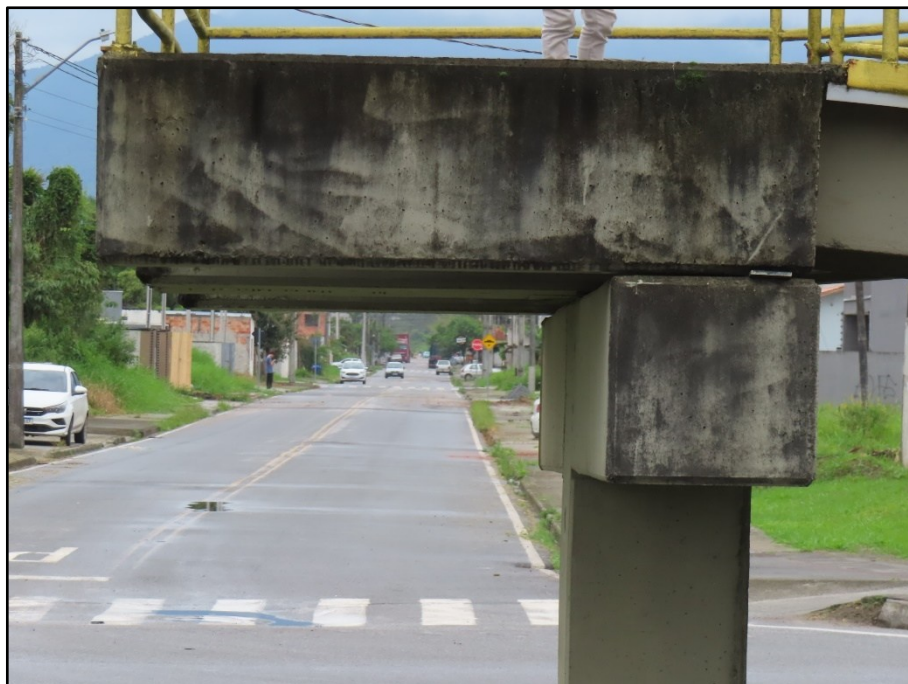
Foto 109 Manchas de umidade na nervura 1 na BL1, face Leste
