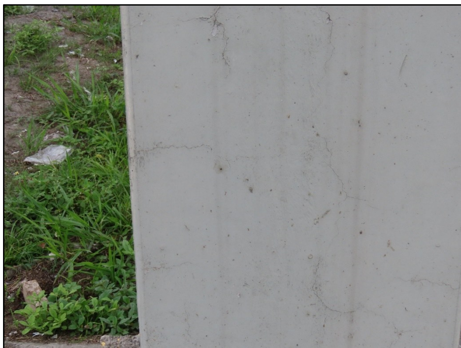
Foto 174 Vista aproximada da foto anterior. Fissuras mapeadas no pilar P6, face Norte.
