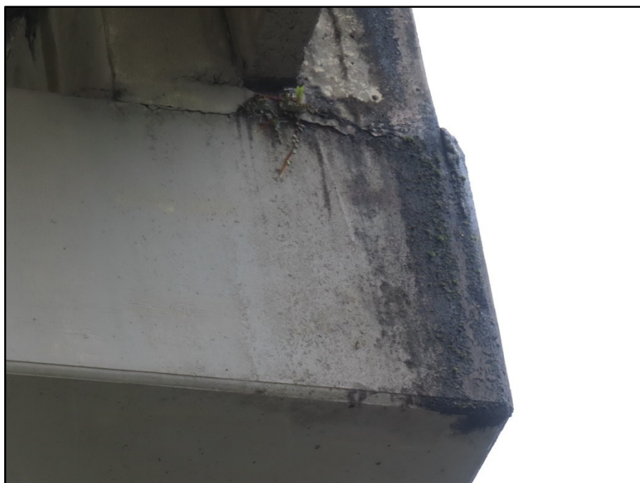
Foto 220 Vista aproximada da foto anterior. Manchas de umidade na VAP4 do pilar P2, face Sul.
