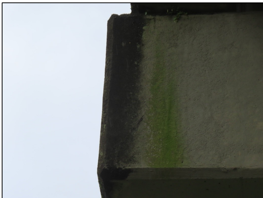
Foto 208 Vista aproximada da foto anterior. Manchas de umidade na VAP2 do pilar P1, face Sul.
