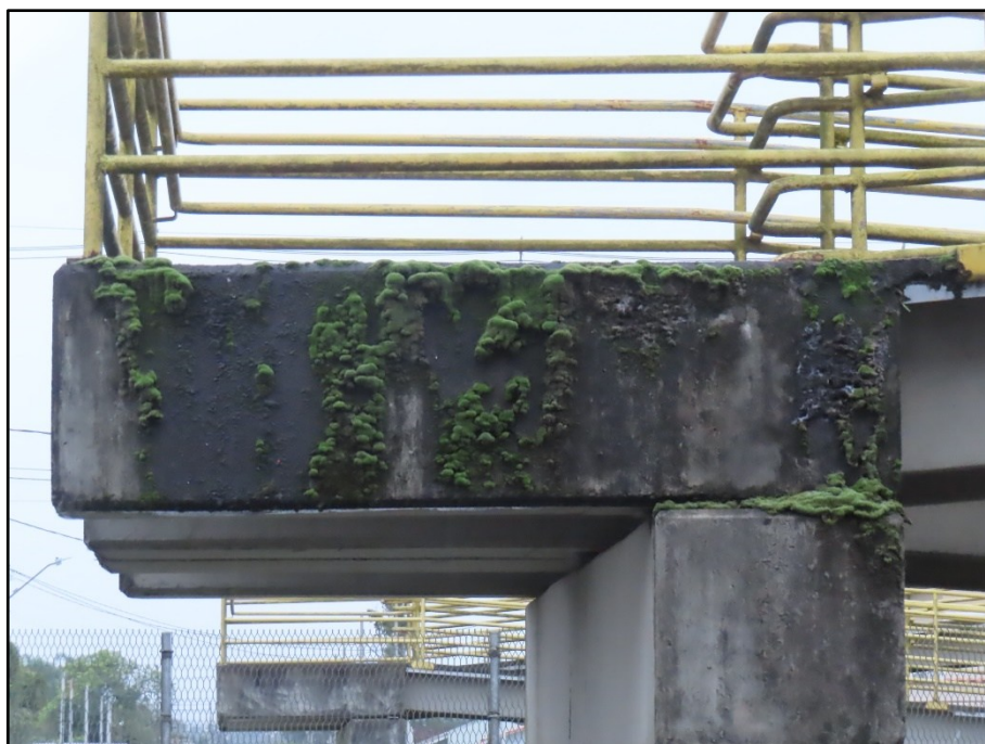
Foto 126 Manchas de umidade na nervura 1 na BL7, face Leste
