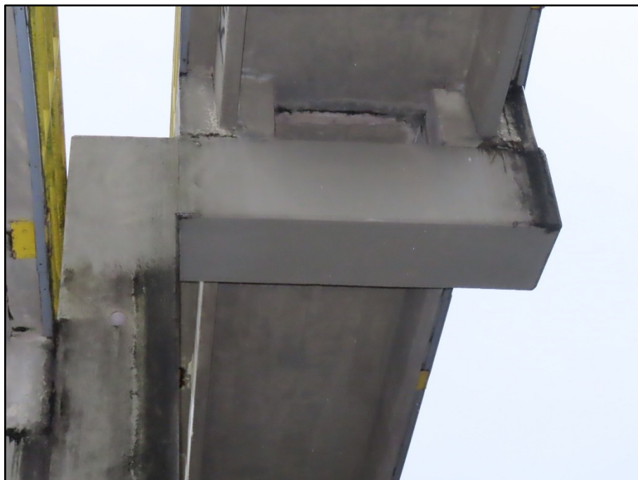
Foto 219 Manchas de umidade na VAP4 do pilar P2, face Sul.
