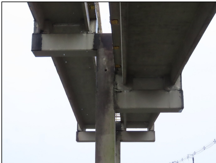
Foto 193 Manchas de umidade no pilar P7, face Sul.
