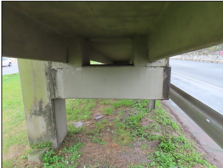
Foto 231 Manchas de umidade na VAP9 do pilar P4, face Sul.
