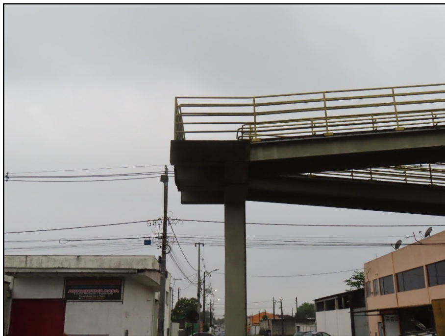
Foto 123 Manchas de umidade na nervura 1 na BL5, face Oeste
