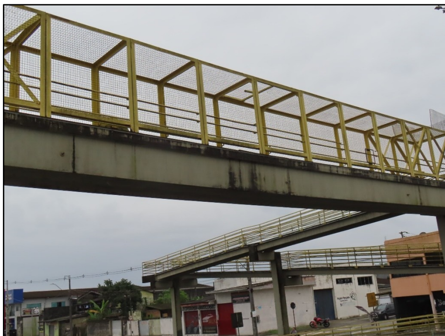
Foto 142 Manchas de umidade no trecho central da viga longarina VL3, face Sul.
