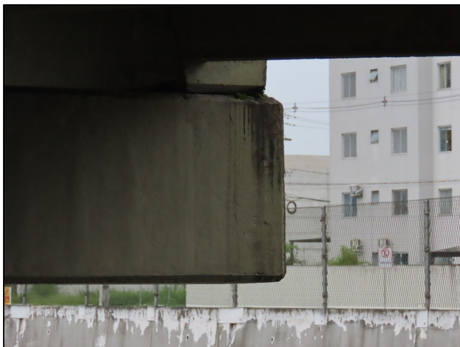
Foto 260 Manchas de umidade na VAP24 do pilar P10, face Norte.
