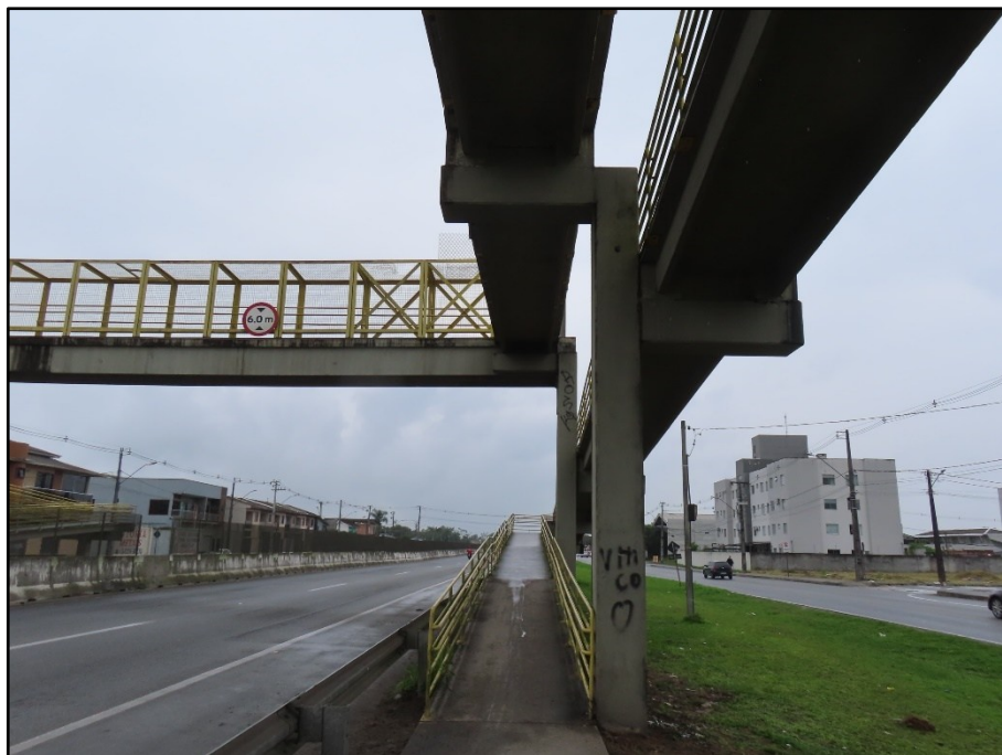
Foto 217 Manchas de umidade na VAP4 do pilar P2, face Norte.
