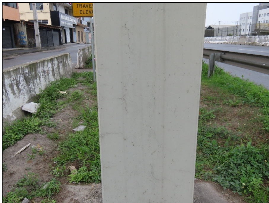
Foto 173 Fissuras mapeadas no pilar P6, face Norte.
