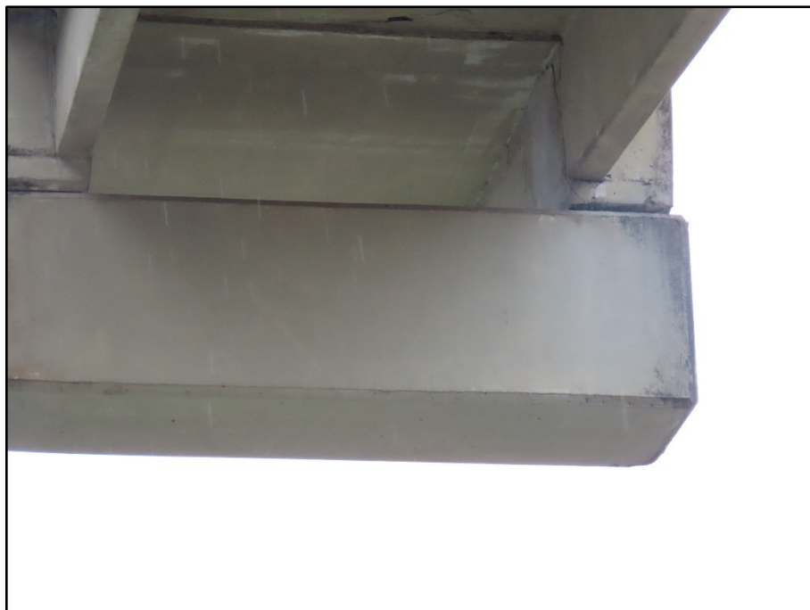
Foto 245 Manchas de umidade na VAP13 do pilar 6, face Sul.
