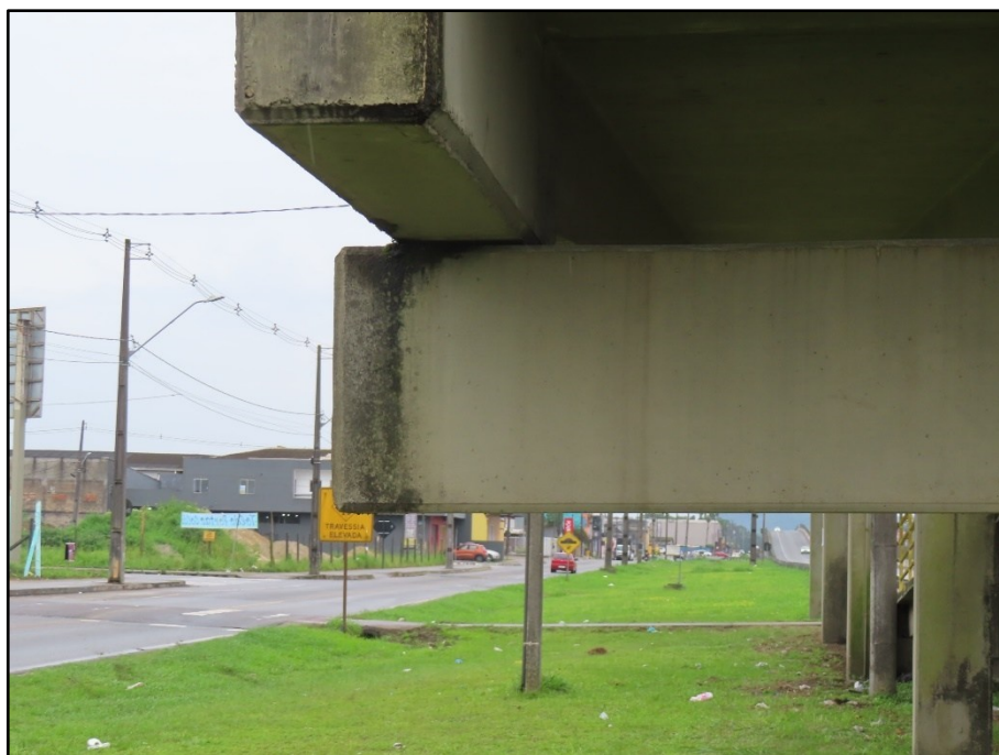
Foto 242 Vista aproximada da foto anterior. Manchas de umidade na VAP12 do pilar P5, face Sul.
