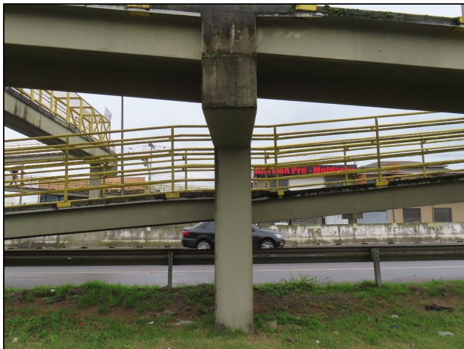
Foto 235 Manchas de umidade na VAP10 do pilar P4, face Oeste.
