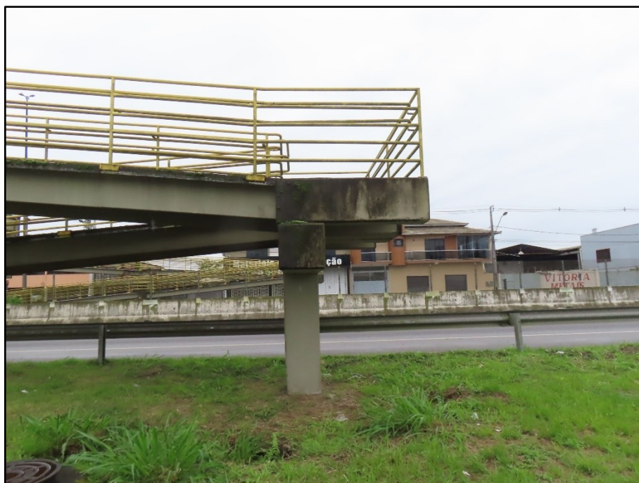
Foto 110 Manchas de umidade na nervura 1 na BL2, face Oeste
