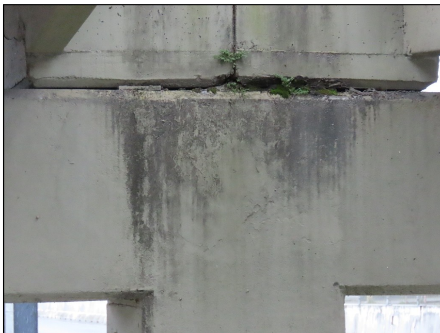
Foto 196 Manchas de umidade no pilar P10, face Norte.
