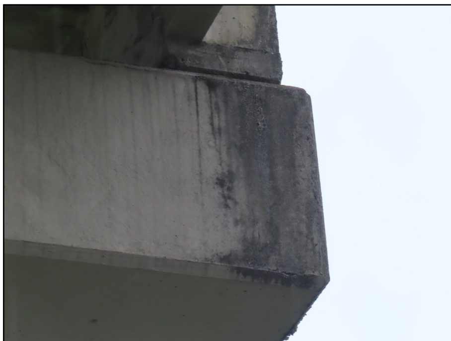
Foto 206 Vista aproximada da foto anterior. Manchas de umidade na VAP1 do pilar P1, face Sul.
