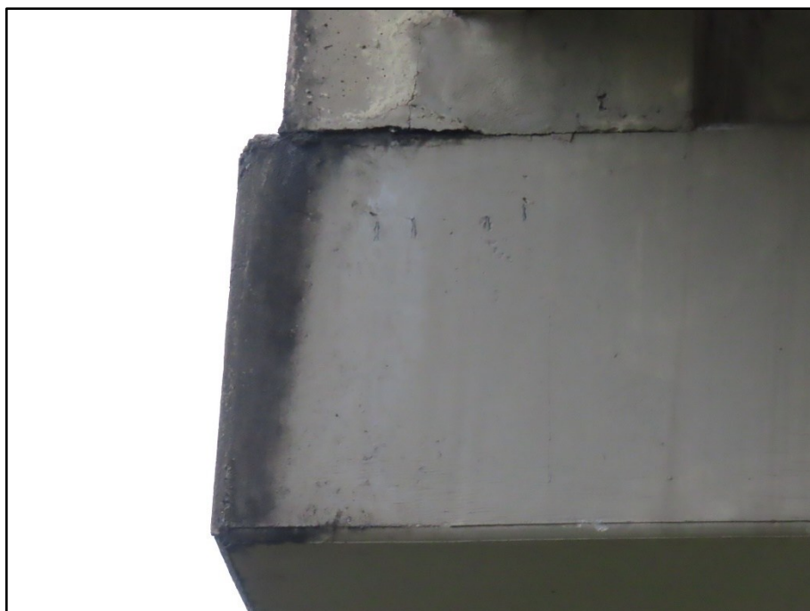
Foto 214 Vista aproximada da foto anterior. Manchas de umidade na VAP3 do pilar P2, face Sul.
