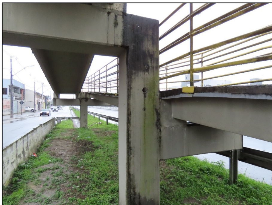
Foto 194 Manchas de umidade no pilar P9, face Norte.
