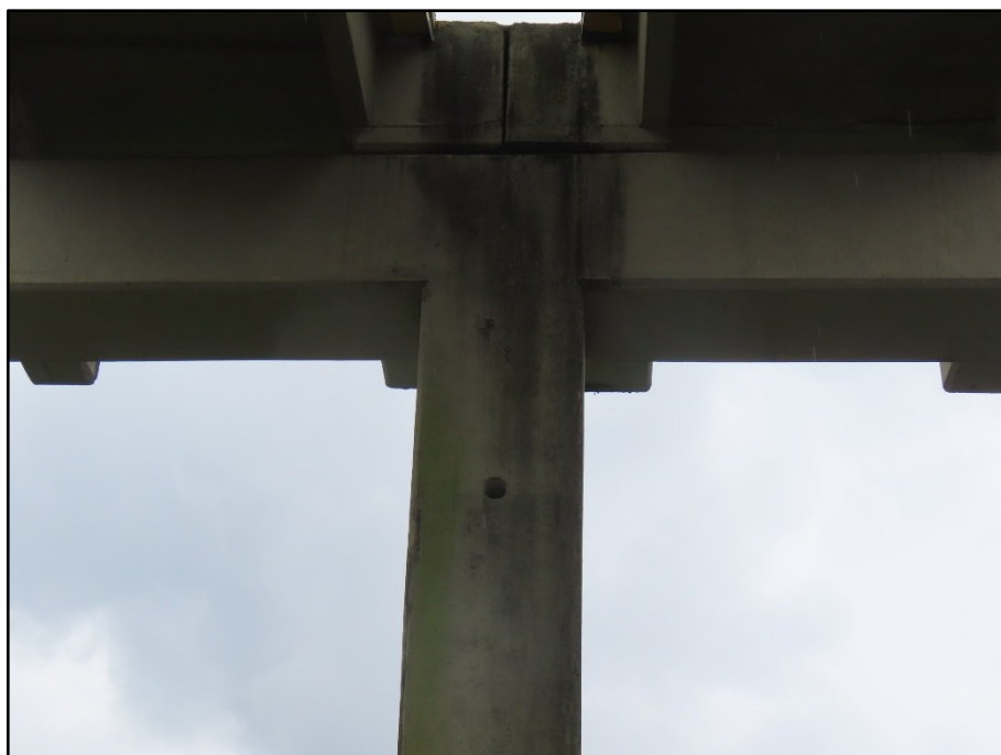
Foto 180 Idem foto anterior. Manchas de umidade no pilar P1, face Sul.
