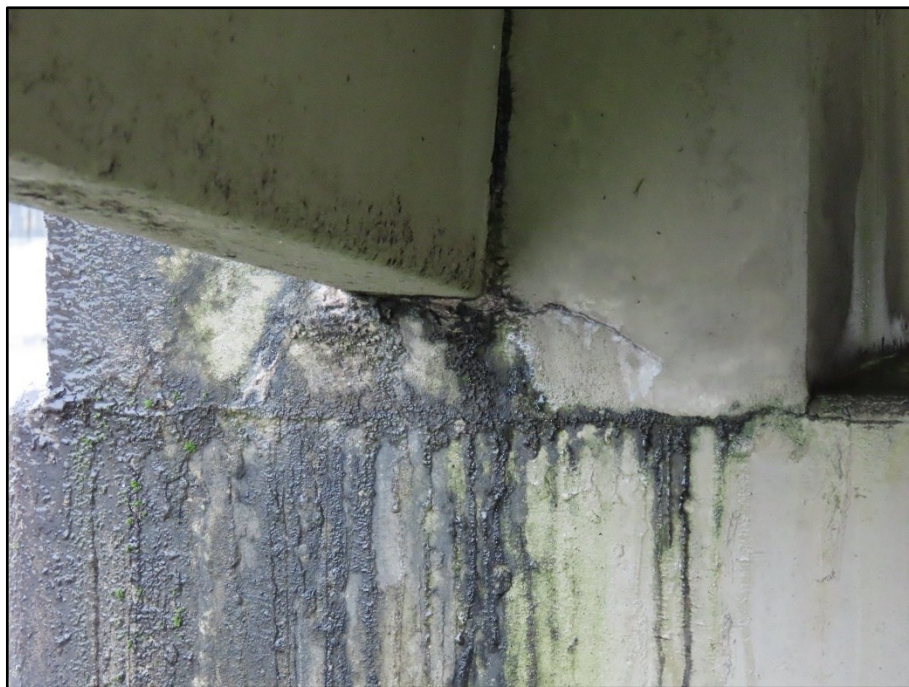
Foto 255 Manchas de umidade na VAP21 do pilar P9, face Sul.
