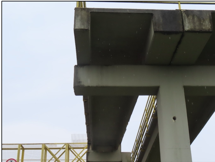
Foto 203 Manchas de umidade na VAP1 do pilar P1, face Norte.
