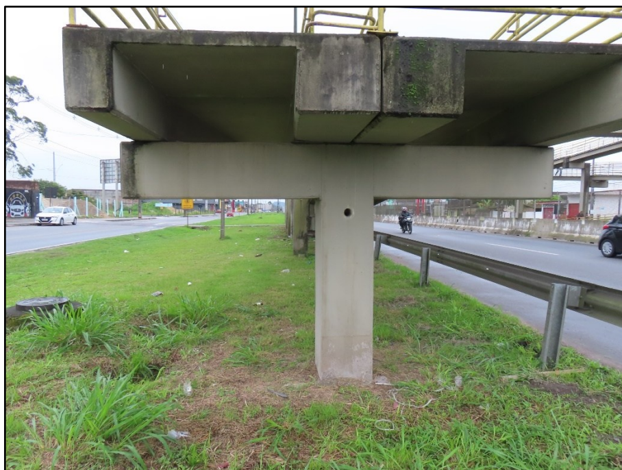
Foto 241 Manchas de umidade na VAP12 do pilar P5, face Sul.
