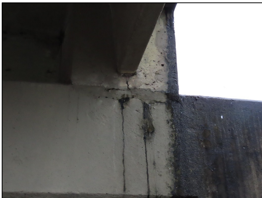
Foto 262 Fissura VAP22 (bloco de apoio) do pilar P9, face Norte.
