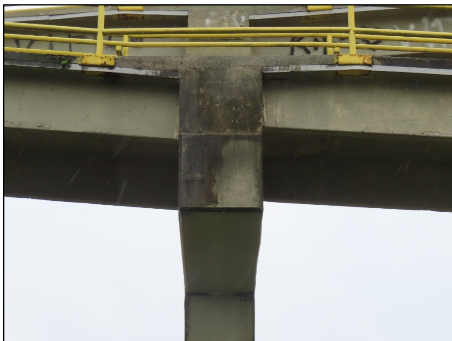
Foto 216 Vista aproximada da foto anterior. Manchas de umidade na VAP3 do pilar P2, face Oeste.
