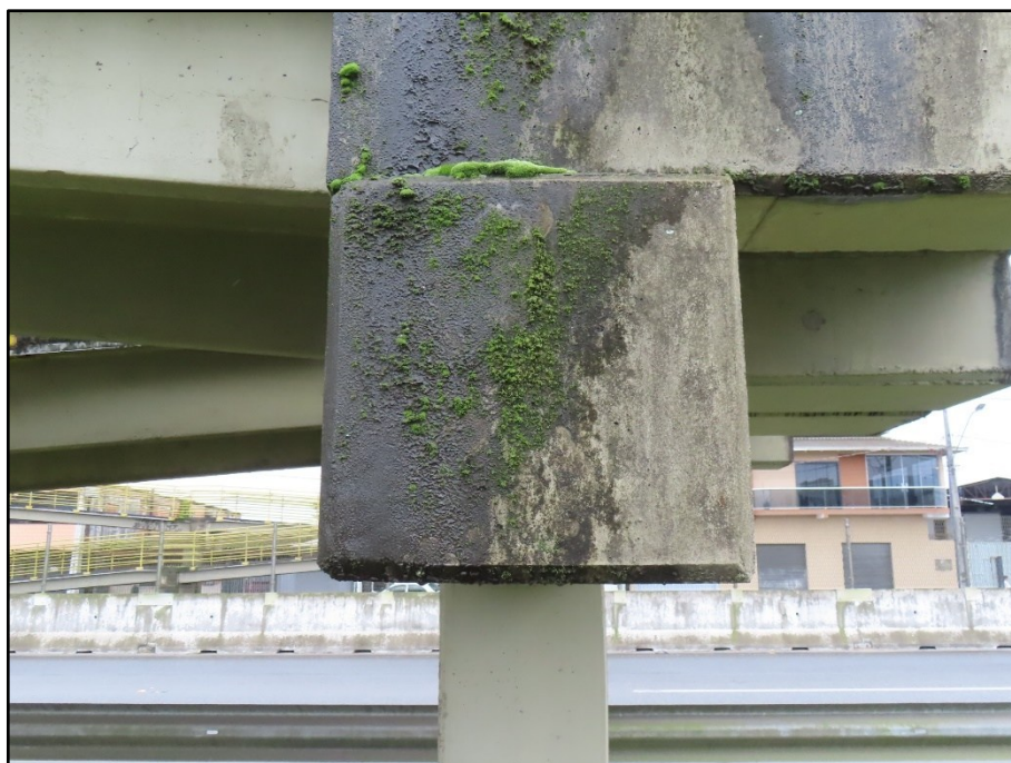
Foto 244 Vista aproximada da foto anterior. Manchas de umidade na VAP12 do pilar P5, face Oeste.
