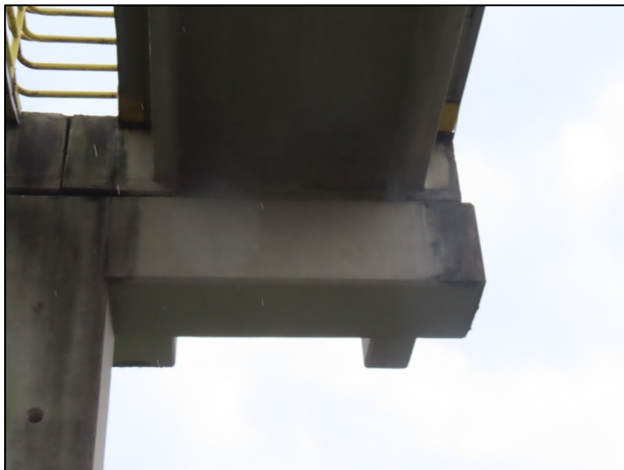
Foto 205 Manchas de umidade na VAP1 do pilar P1, face Sul
