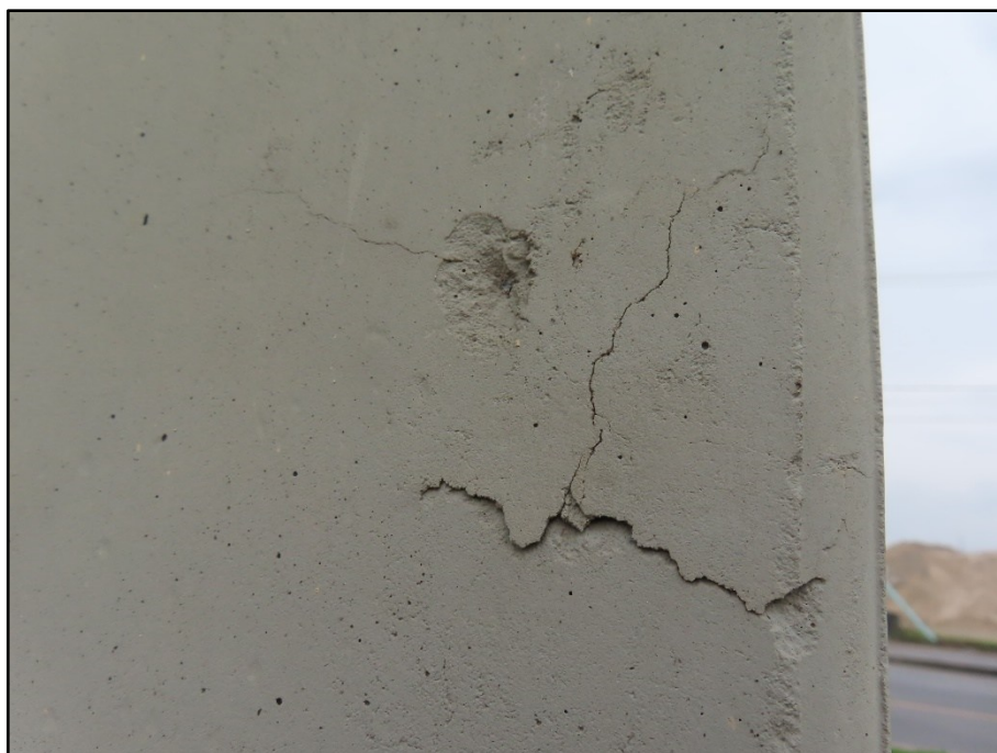
Foto 176 Vista aproximada da todo anterior. Concreto disgregado no pilar P1, face Leste.
