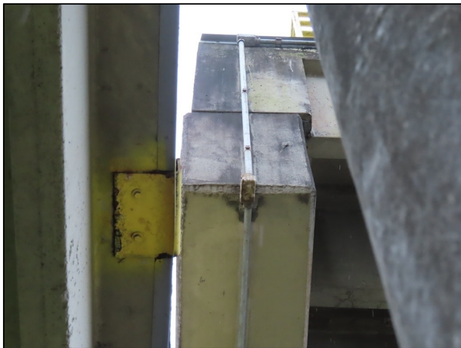
Foto 229 Manchas de umidade na VAP8 do pilar P3, face Sul.
