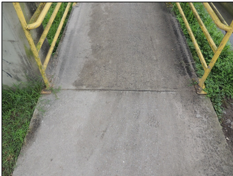
FOTO 059 Vista da junta do ENC2.
