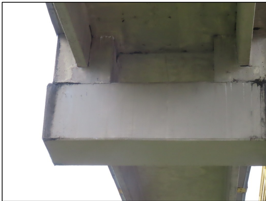
Foto 213 Manchas de umidade na VAP3 do pilar P2, face Sul.
