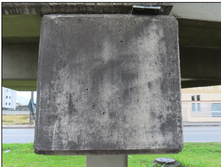
Foto 238 Vista aproximada da foto anterior. Manchas de umidade na VAP11 do pilar 5, face Leste.
