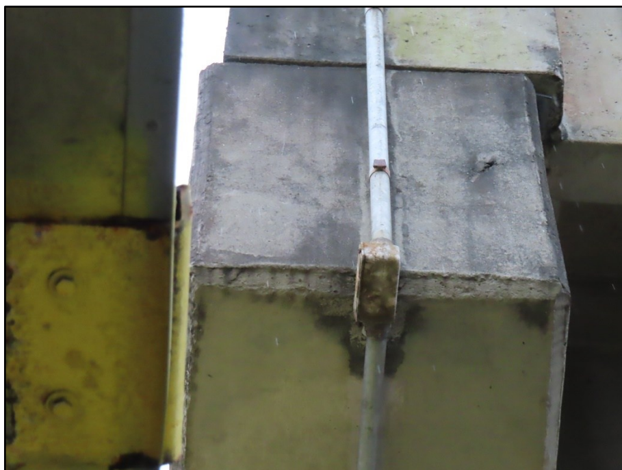
Foto 230 Vista aproximada da foto anterior. Manchas de umidade na VAP8 do pilar P3, face Sul.
