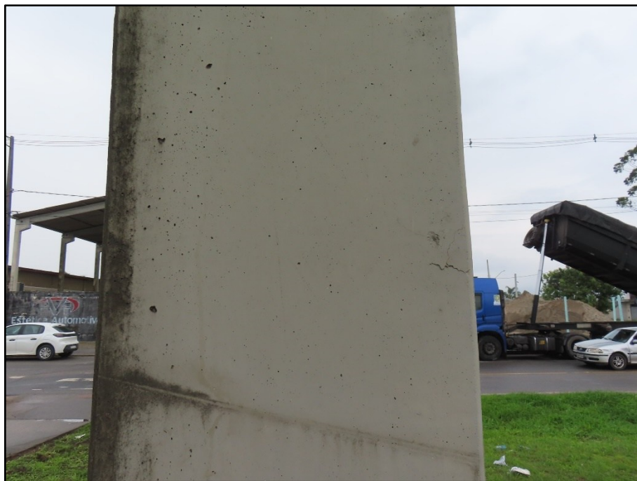
Foto 175 Concreto disgregado no canto do pilar P1, face Leste.
