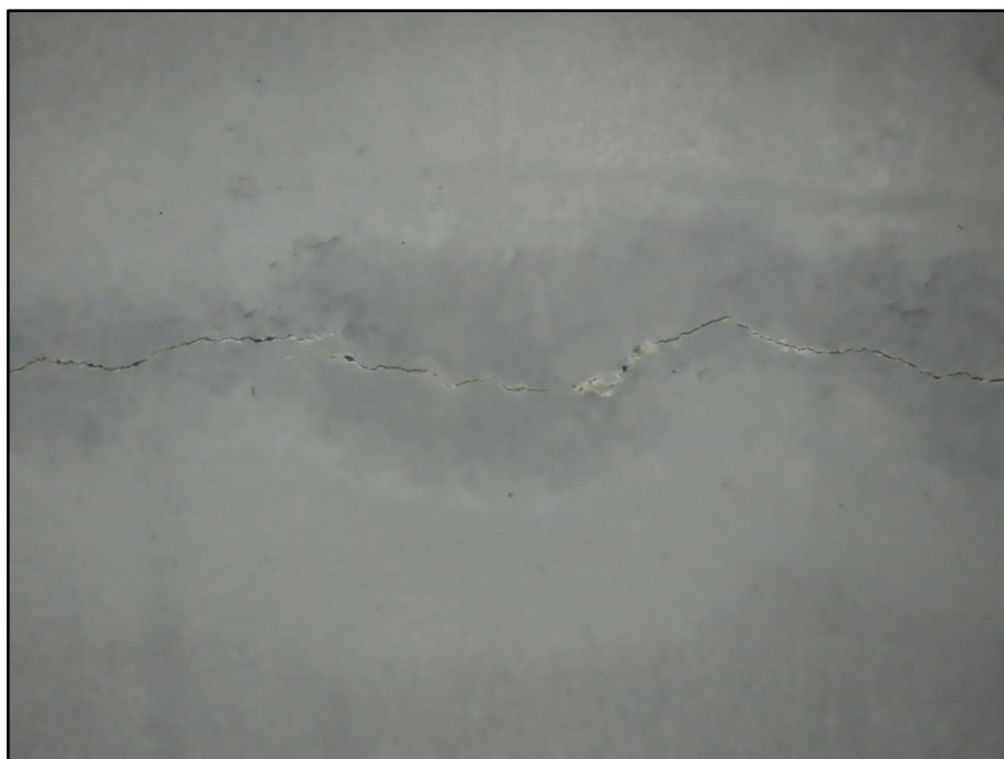
Foto 094 Fissuras na rampa 6, próximo do pilar P1, face Inferior
