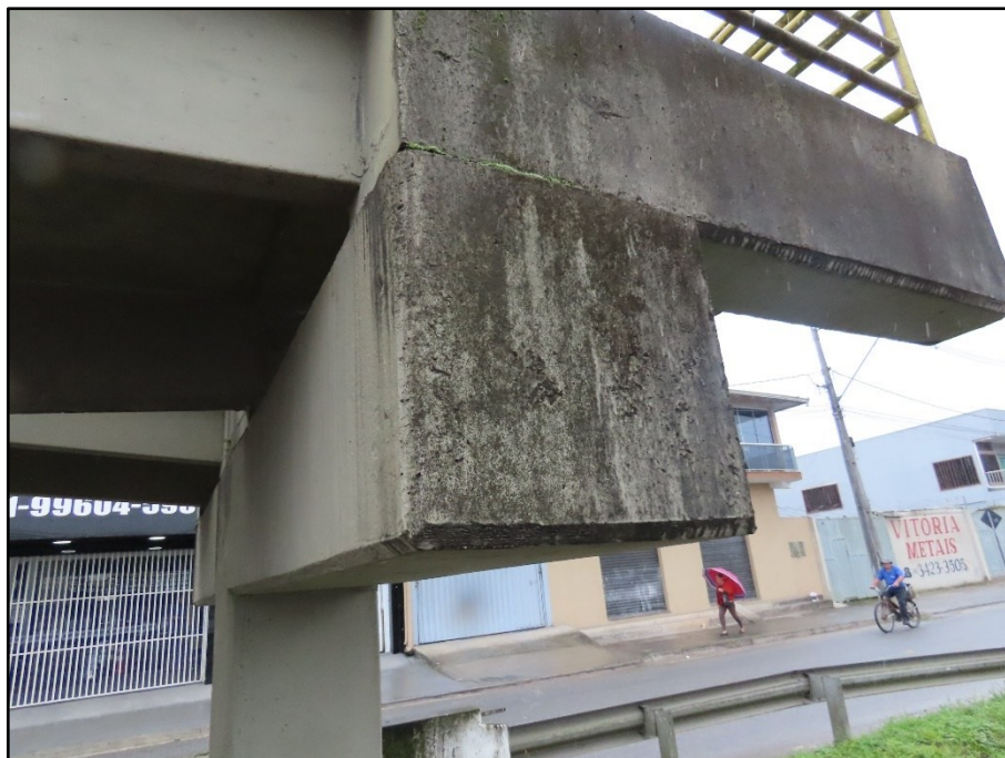
Foto 261 Manchas de umidade na VAP24 do pilar P10, face Oeste.
