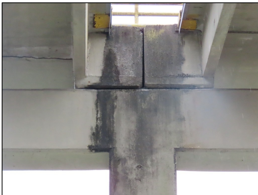
Foto 192 Vista aproximada da foto anterior. Manchas de umidade no pilar P6, face Sul.
