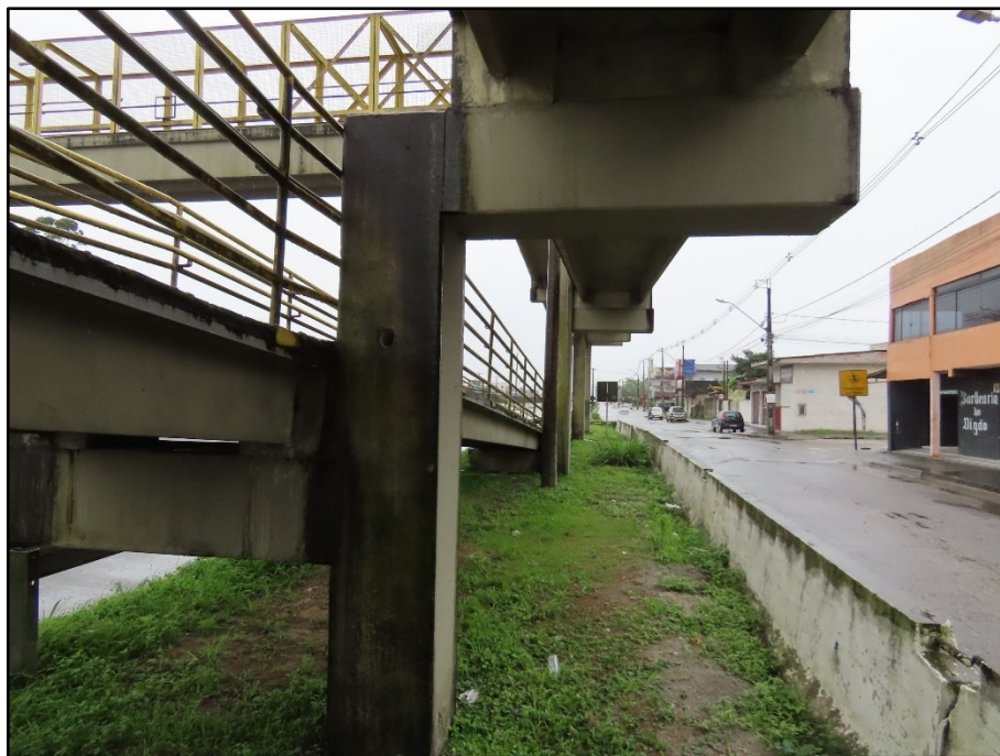
Foto 195 Manchas de umidade no pilar P9, face Sul.
