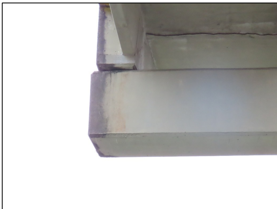
Foto 246 Manchas de umidade na VAP14 do pilar 6, face Sul.
