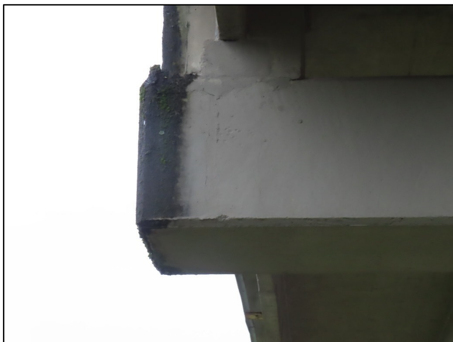
Foto 226 Vista aproximada da foto anterior. Manchas de umidade na VAP6 do pilar P3, face Sul.
