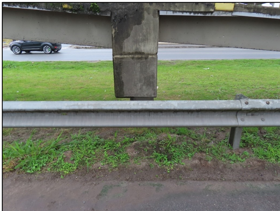
Foto 233 Manchas de umidade na VAP9 do pilar P4, face Leste.
