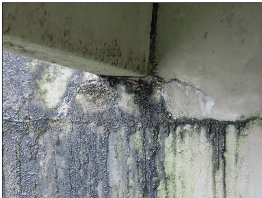
Foto 256 Vista aproximada da foto anterior. Manchas de umidade na VAP21 do pilar P9, face Sul.
