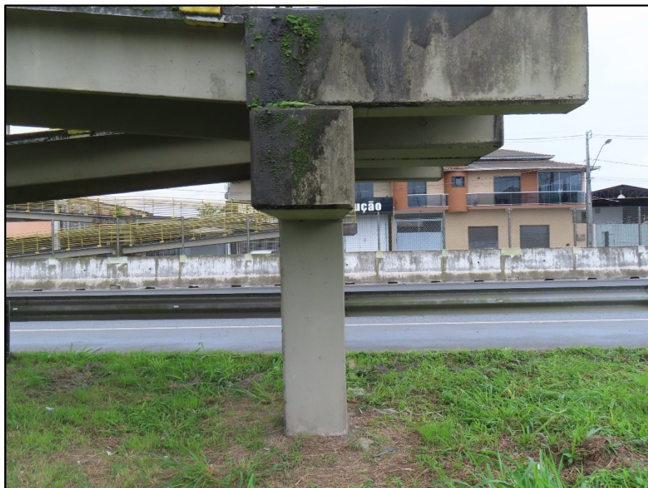
Foto 243 Manchas de umidade na VAP12 do pilar P5, face Oeste.
