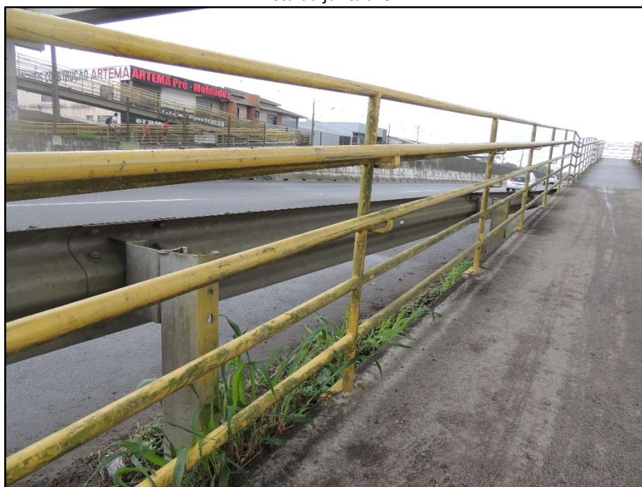
FOTO 078 Vista do guarda-corpo GC1 a partir do acesso1.
