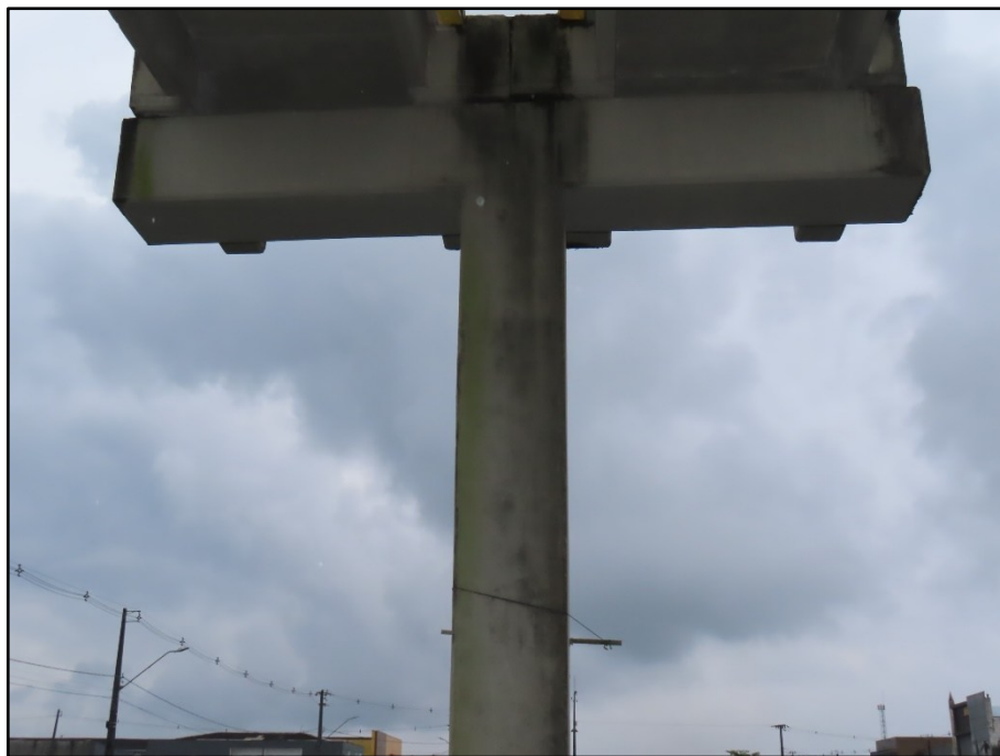
Foto 179 Manchas de umidade no pilar P1, face Sul.
