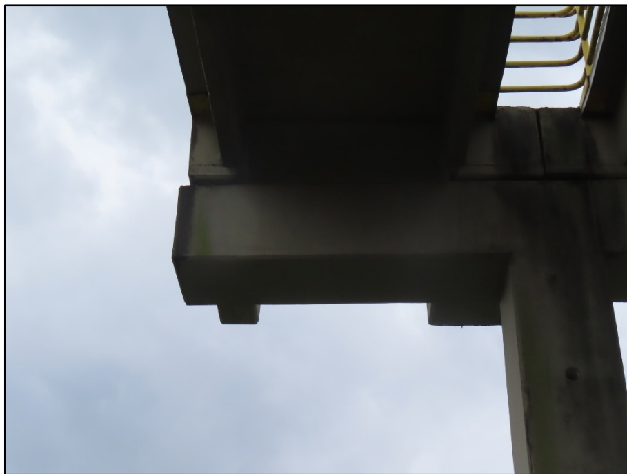
Foto 207 Manchas de umidade na VAP2 do pilar P1, face Sul.
