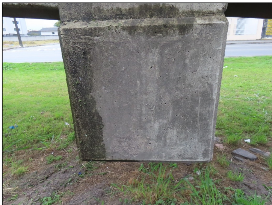
Foto 234 Vista aproximada da foto anterior. Manchas de umidade na VAP9 do pilar P4, face Leste.
