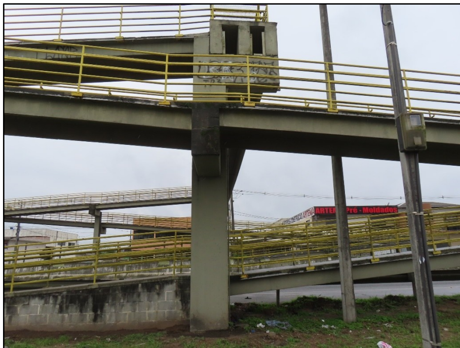
Foto 227 Manchas de umidade na VAP 6 do pilar P3, face Oeste.
