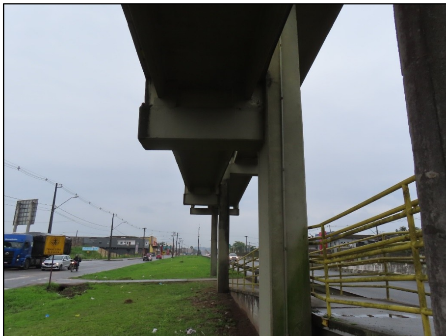
Foto 225 Manchas de umidade na VAP6 do pilar P3, face Sul.
