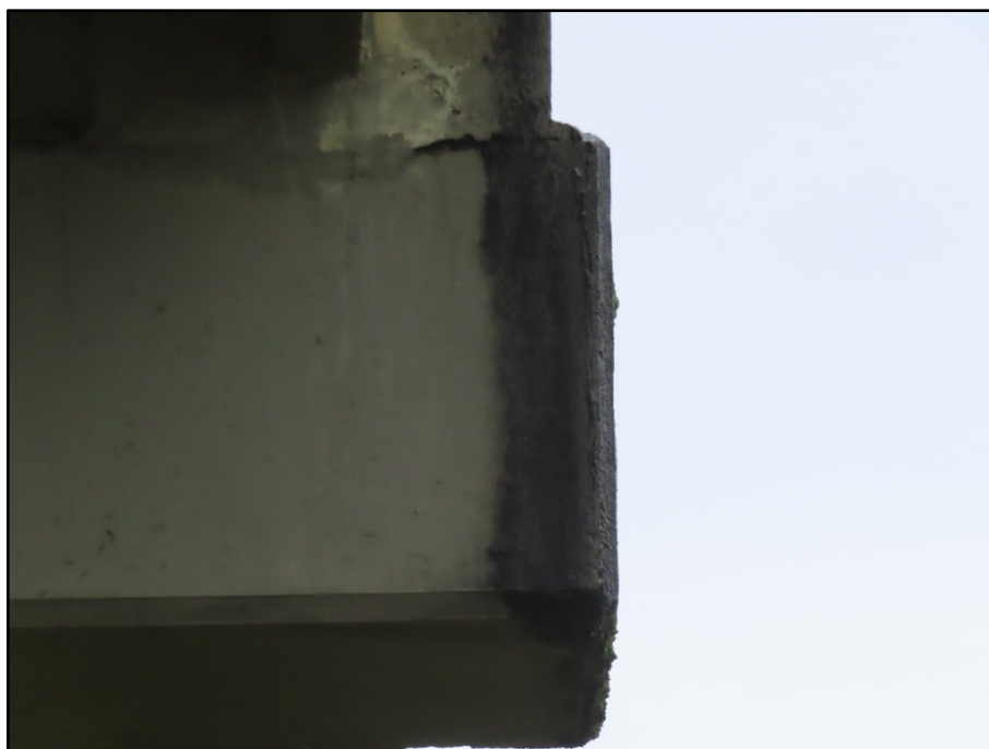
Foto 224 Vista aproximada da foto anterior. Manchas de umidade na VAP6 do pilar P3, face Norte.
