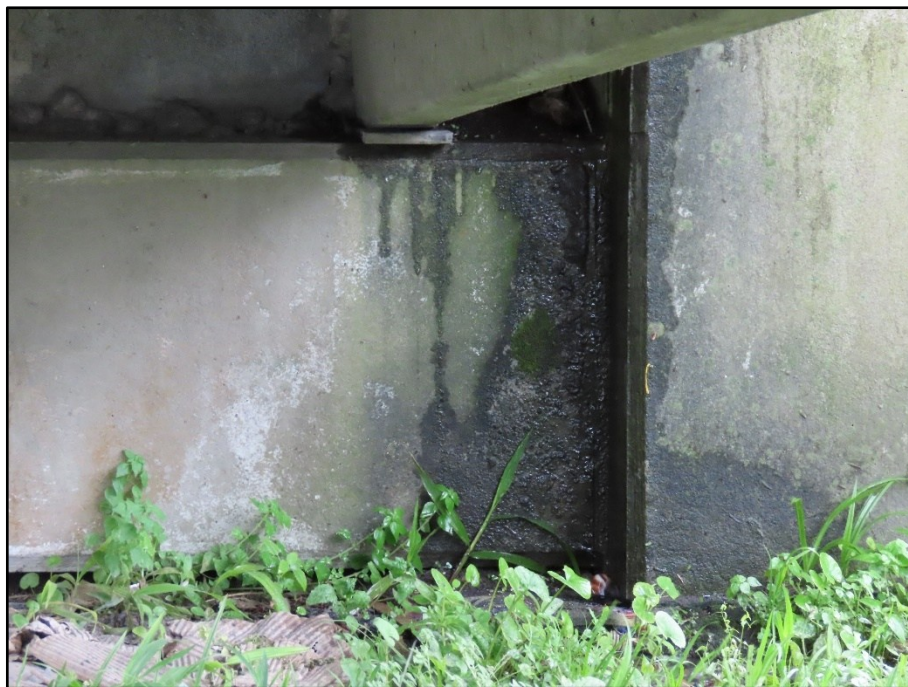
Foto 251 Manchas de umidade na VAP17 do pilar P8, face Sul.
