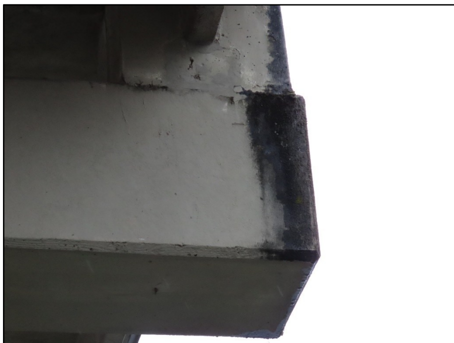
Foto 254 Vista aproximada da foto anterior. Manchas de umidade na VAP18 do pilar P8, face Sul.
