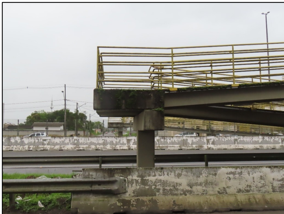
Foto 125 Manchas de umidade na nervura 1 na BL7, face Leste
