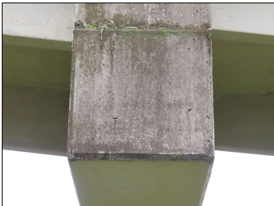
Foto 236 Vista aproximada da foto anterior. Manchas de umidade na VAP10 do pilar P4, face Oeste.
