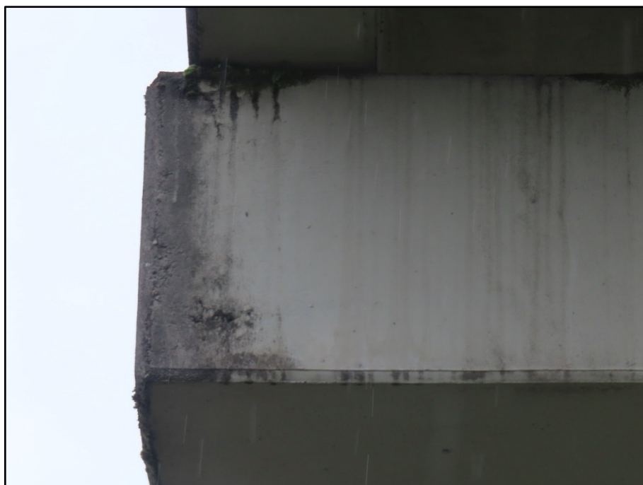
Foto 204 Vista aproximada da foto anterior. Manchas de umidade na VAP1 do pilar P1, face Norte.
