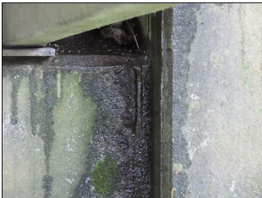
Foto 252 Vista aproximada da foto anterior. Manchas de umidade na VAP17 do pilar P8, face Sul.
