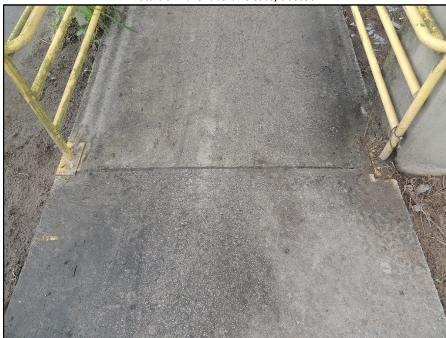
FOTO 058 Vista da junta do ENC1.
