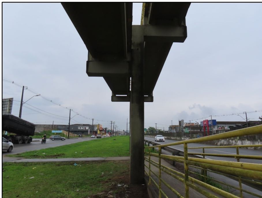
Foto 181 Manchas de umidade no pilar P2, face Sul.
