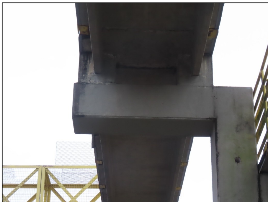
Foto 218 Vista aproximada da foto anterior. Manchas de umidade na VAP4 do pilar P2, face Norte.
