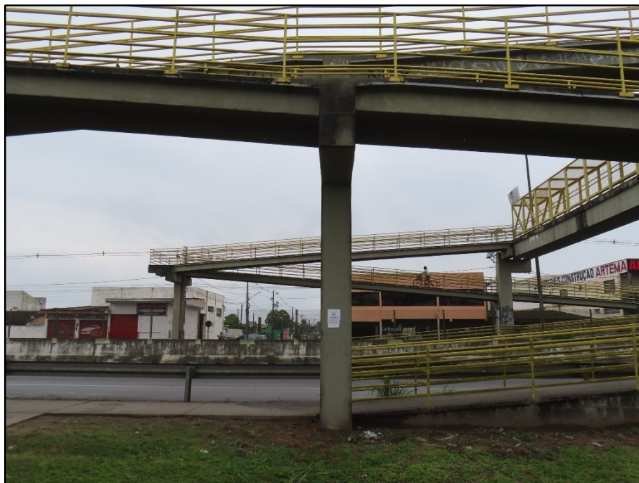
Foto 215 Manchas de umidade na VAP3 do pilar P2, face Oeste.
