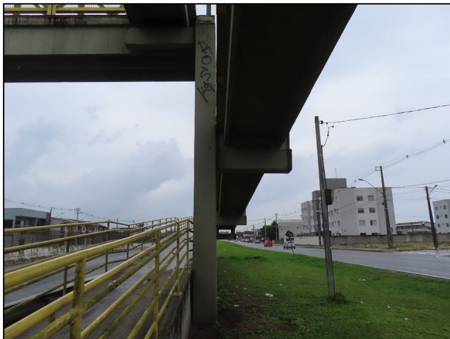
Foto 223 Manchas de umidade na VAP6 do pilar P3, face Norte.
