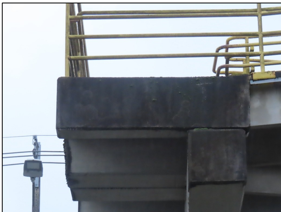
Foto 124 Manchas de umidade na nervura 1 na BL5, face Oeste
