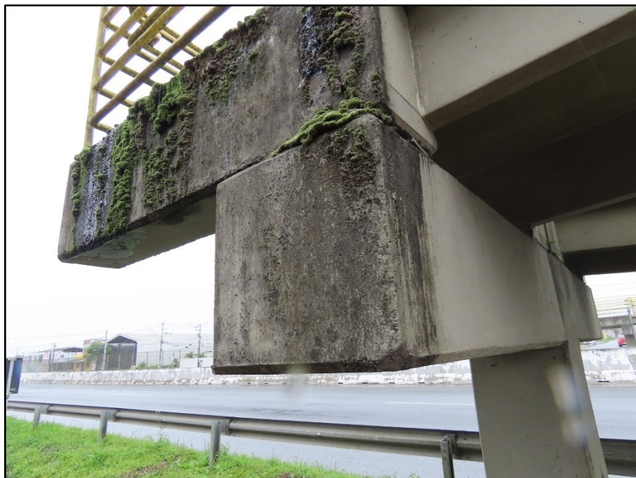
Foto 259 Manchas de umidade na VAP23 do pilar P10, face Leste.
