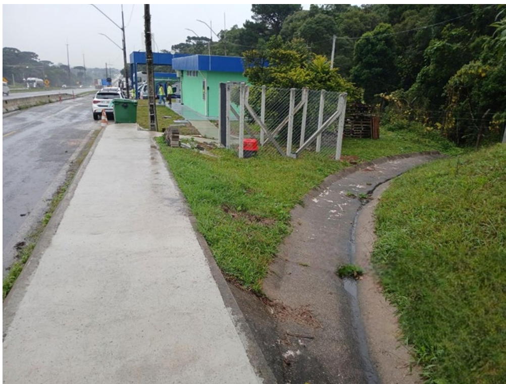
Imagem 5 – Sistema de Drenagem
